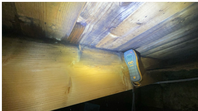
Synlig og målbar fukt i taktro nedenfor pipe.
