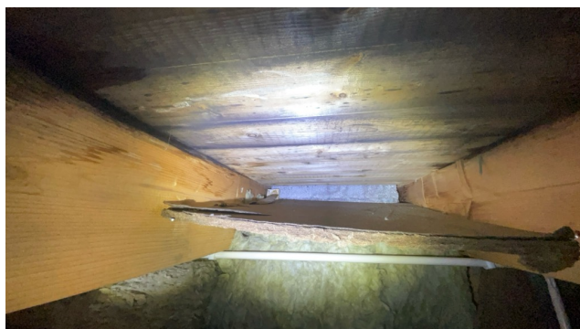
Pipe på overside av sverte/fukt i taktro
