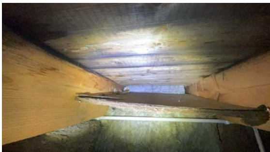
Pipe på overside av sverte/fukt i taktro
