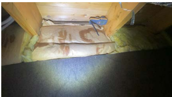
Skjolder, sverte etter fukt/kondens ved sentralviften, men tørt befaringsdagen (opplyst kan oppstå ved spesielle værforhold)
