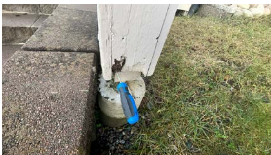
Mindre råte bunn tresøyle
