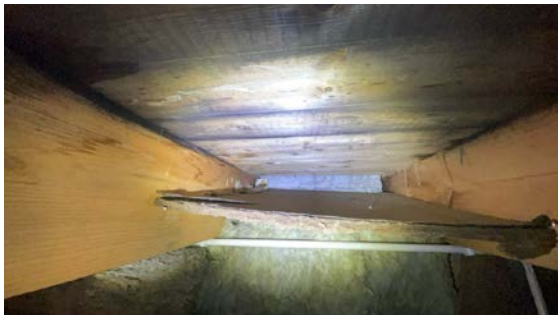
Pipe på overside av sverte/fukt i taktro
