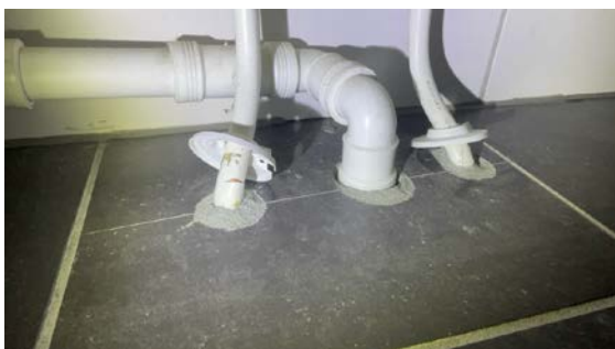
Ikke synlige mansjetter/membran ved rør
