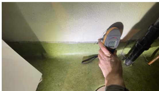
Mindre forhøyning ved fuktsøk i nedkant mur
