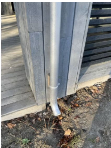
Det er montert utkast på nedløpsrør.
