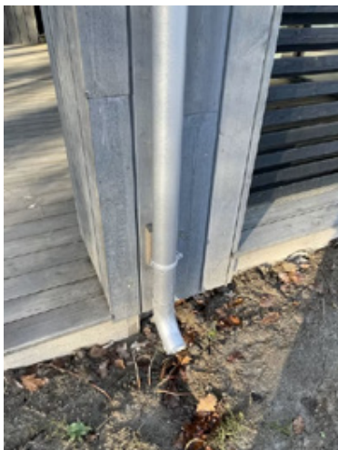
Det er montert utkast på nedløpsrør.
