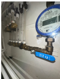
Samleskap med rørkurser og stoppekraner
