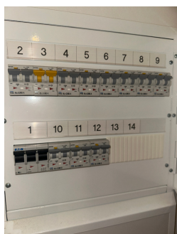
Sikringsskap med automatsikringer.
