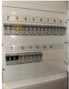
Sikringsskap med automatsikringer.
