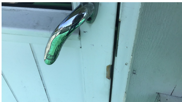
skade på balkongdør
