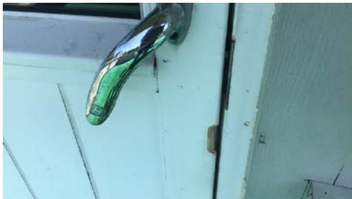
skade på balkongdør
