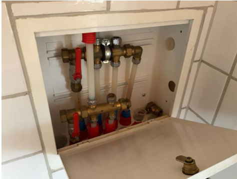
Rørskap på bad i 2. etasje.
