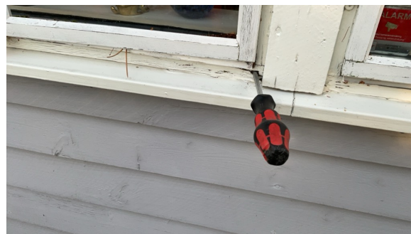
Råteskader i vinduer på stue.
