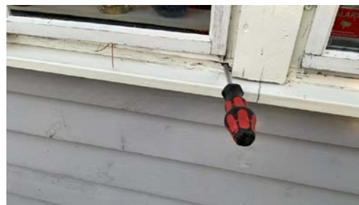
Råteskader i vinduer på stue.
