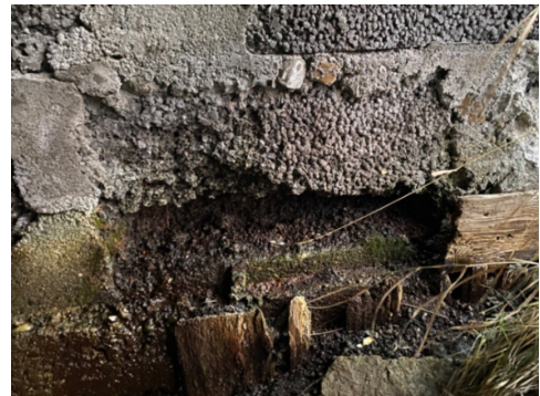
Svekkelser i nedre del av mur.
