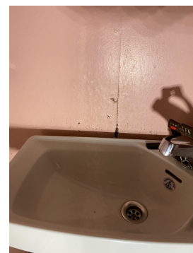
Fuktskjolder i veggplater bak vask.
