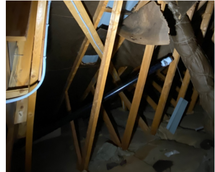
Blendet rør for lufting fra kloakk.
