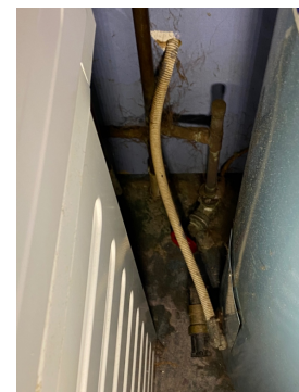
Tilkobling varmtvannstank. Løse ledning.
