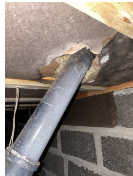
Rørgjennomføring fra avløp må tettes.
