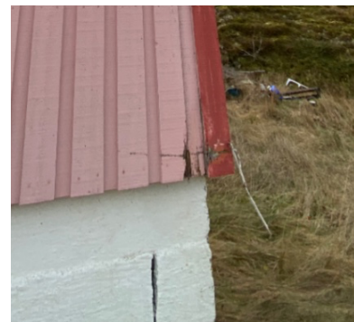
Skader/råteskader i kledning.
