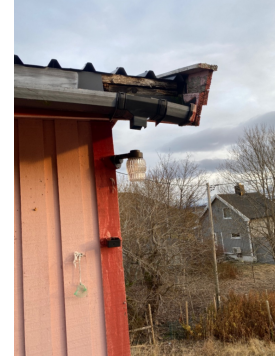
Taket mangler nedløpsrør, beslag fra tak til renne mangler.
