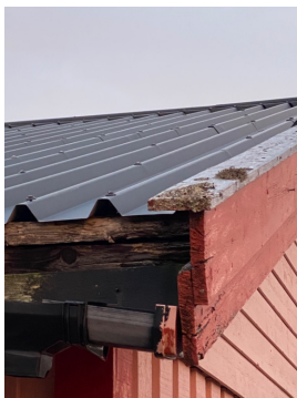
Takrenner, nedløpsrør må etableres, råteskade materiale må byttes.
