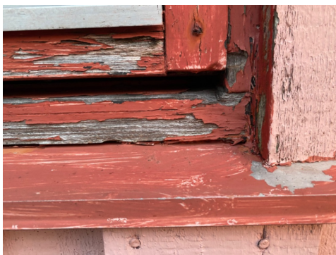
Råteskader i vindu.
