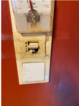
Skade i deksel. Tegn på varmgang.
