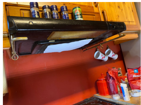
Funksjonstest av ventilator.
