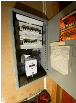
El-skap med automatsikringer, plassert på bod.
