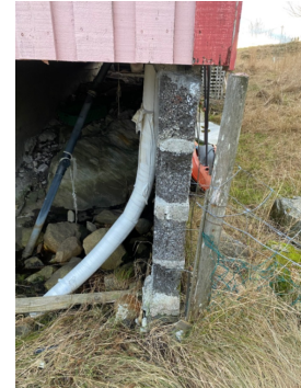
Underdimensjonert mur i leca, Skjevheter og riss/sprekker i muren.
