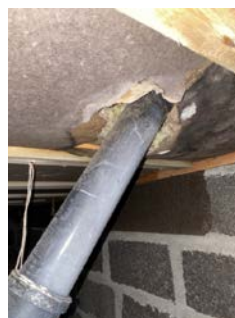
Rørgjennomføring fra avløp må tettes.
