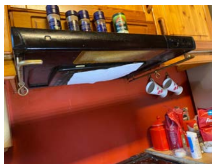
Funksjonstest av ventilator.
