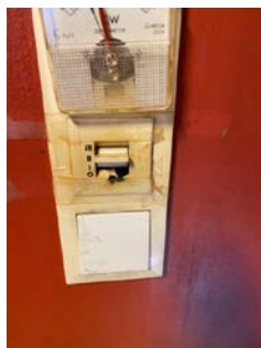
Skade i deksel. Tegn på varmgang.
