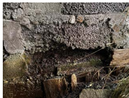
Svekkelser i nedre del av mur.
