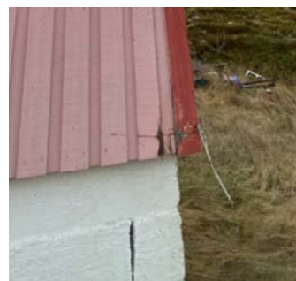
Skader/råteskader i kledning.
