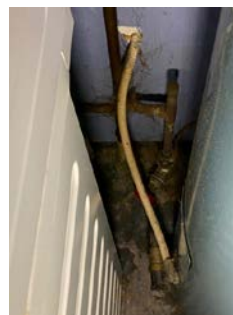
Tilkobling varmtvannstank. Løs ledning.
