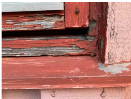
Råteskader i vindu.
