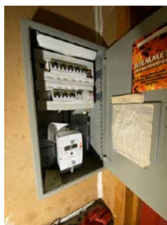
El-skap med automatsikringer, plassert på bod.
