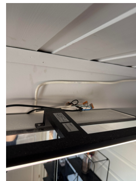
Bildet viser strømførende kabel som ikke er festet til veggen.
