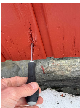
Bildet viser kledningsbord med råte i nedre del av bordene.
