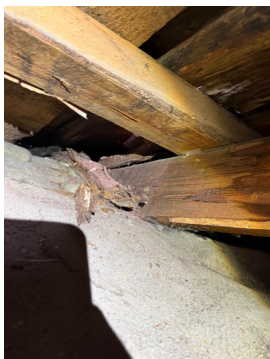
Bilde viser røte i undertak og fuktskjolder.
