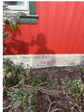
Bildet viser sprekke i grunnmuren.
