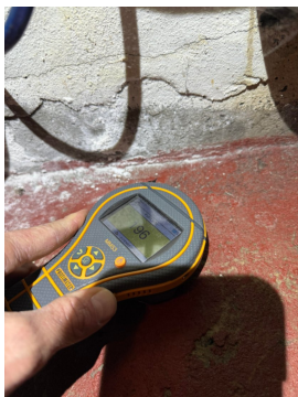
Bildet viser tegn til saltutsalg på muren i boden
