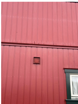
Bildet viser kledningsbord med råte i nedre del av bordene over vannbrettet.
