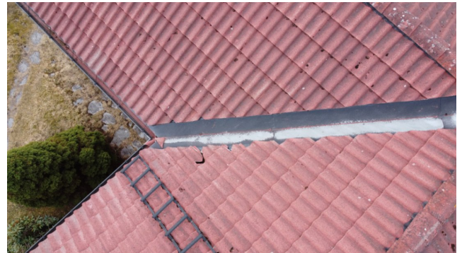
Bildet viser knekt takstein i kilrenne.
