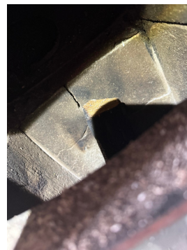
Bildet viser sprekker i ildfast stein i vedovn på soverommet i 1. etasje.
