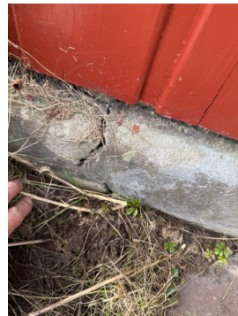
Bildet viser sprekke i grunnmuren.
