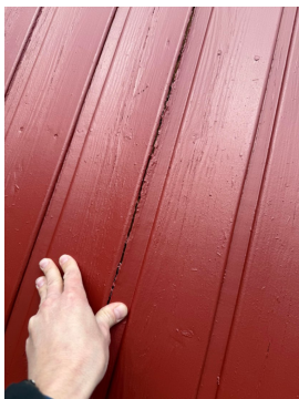
Bildet viser kledningsbord som har sklidd fra hverandre.
