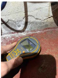
Bildet viser tegn til saltutslag på muren i boden
