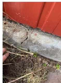
Bildet viser sprekke i grunnmuren.
