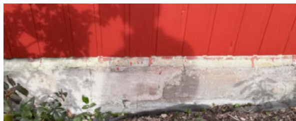
Bildet viser lite, til ingen lufting i nedre kant av kledning mot grunnmur.
