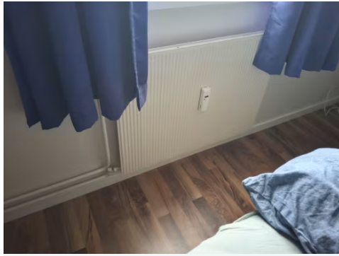
Leiligheten er oppvarmet med radiatorer tilknyttet fjernvarme.
