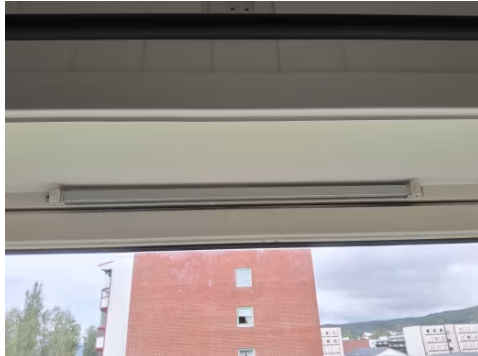
Naturlig tilluft fra spalteventiler i vinduer.
