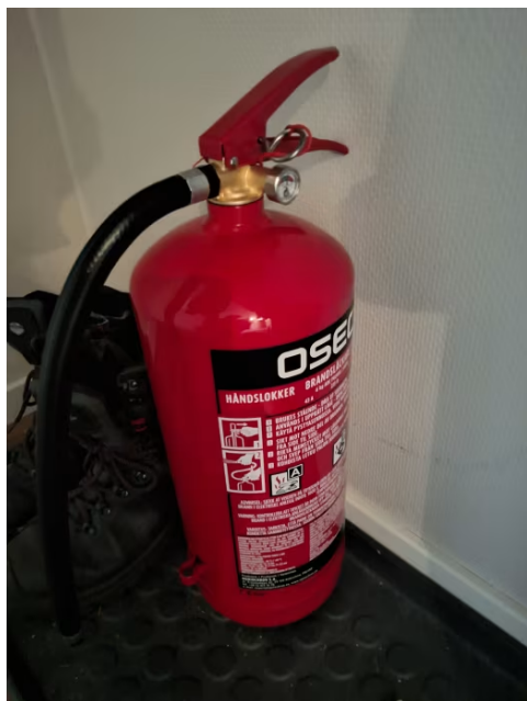
Brannslukningsapparat er plassert i entré.
