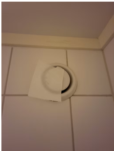
Avtrekkseffekt er testet med papir.
