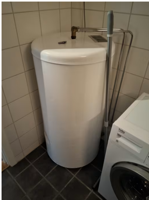
Varmtvannsbereder er plassert på bad.
