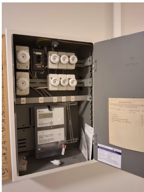
Sikringsskap med skrusikringer er plassert i felles gang.
