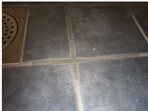
Lokal vannsamling ved sluk.
