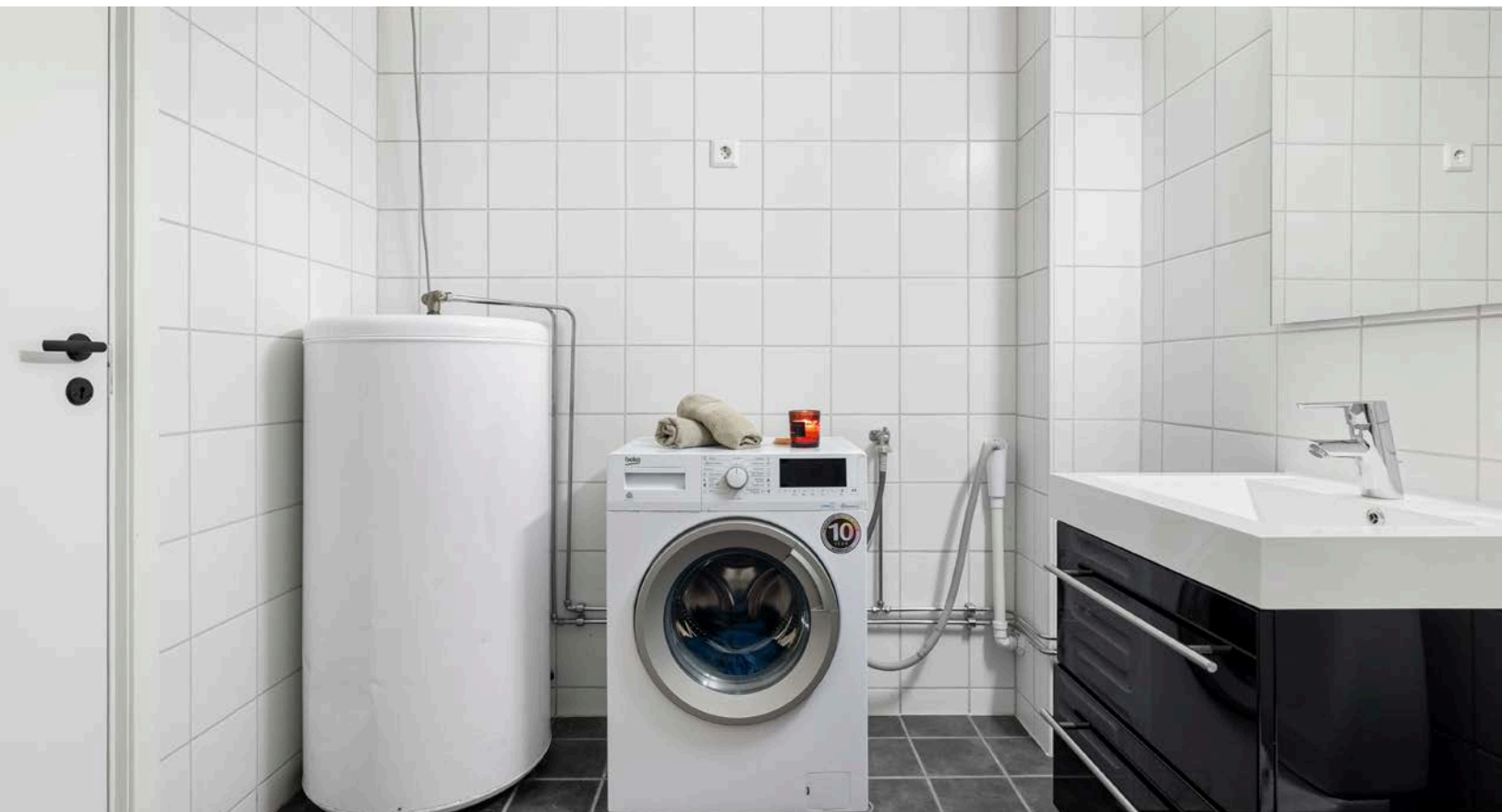
Det er opplegg for vaskemaskin på badet.
