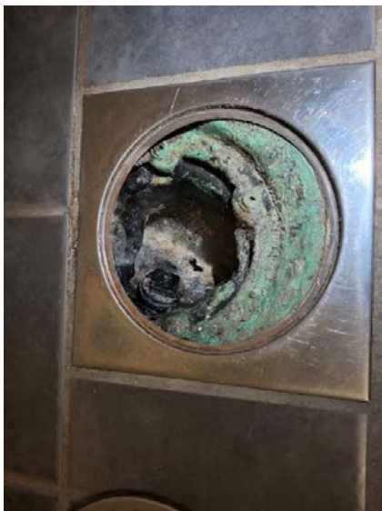
Sluk er ikke skiftet, overgang til membran kan ikke verifiseres.
