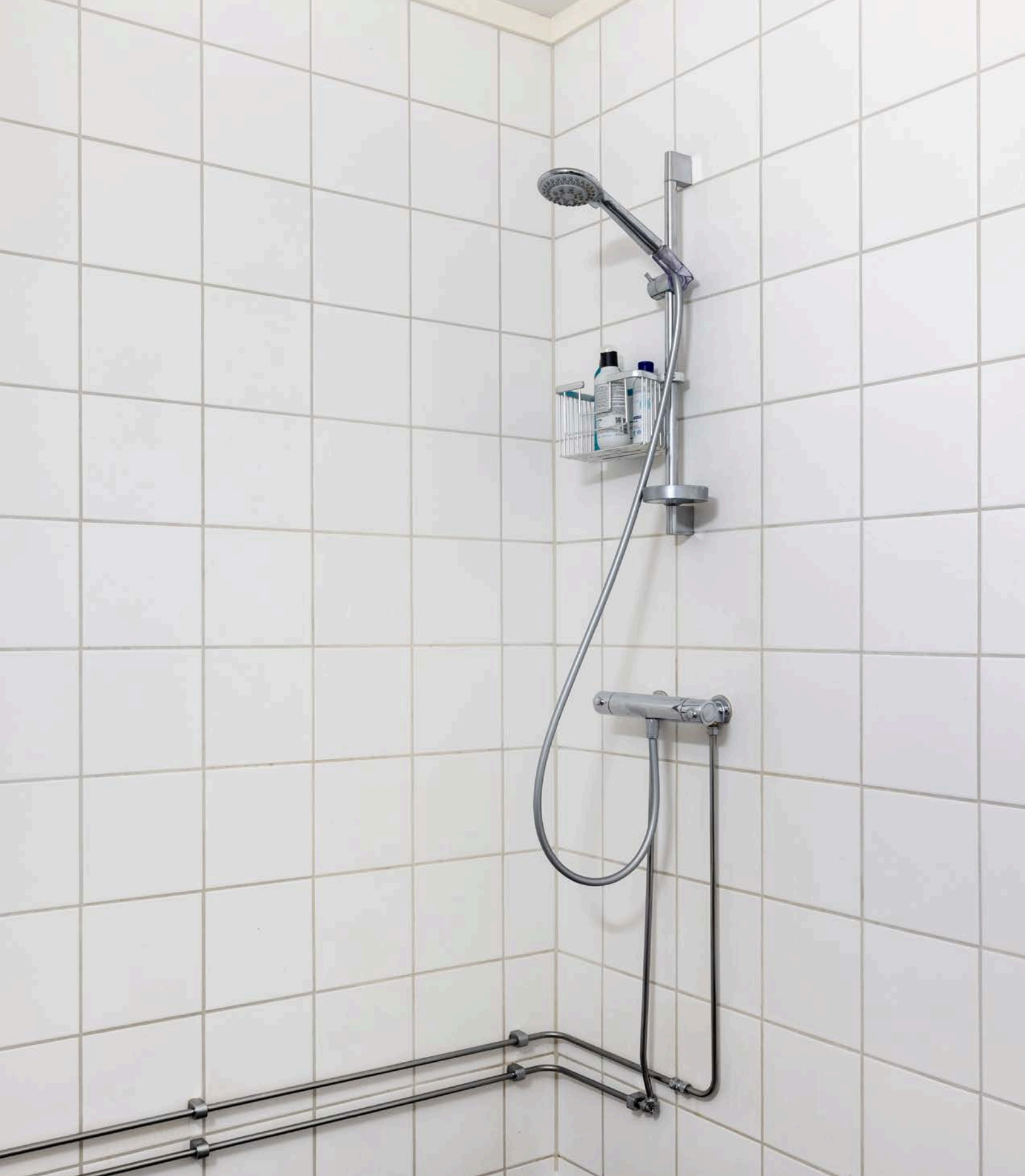
Dusjhjørne med veggmontert dusjbatteri.
