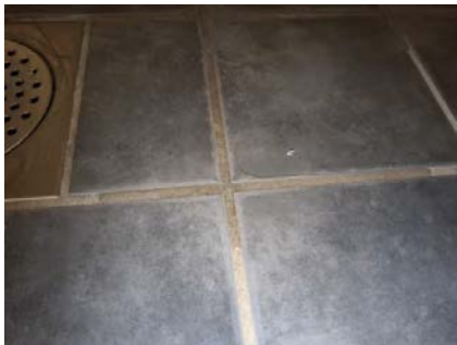
Lokal vannsamling ved sluk.
