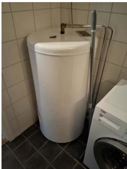
Varmtvannsbereder er plassert på bad.
