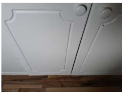
Kjøkkeninnredning har stedvise skader.
