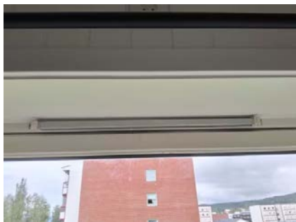
Naturlig tilluft fra spalteventiler i vinduer.
