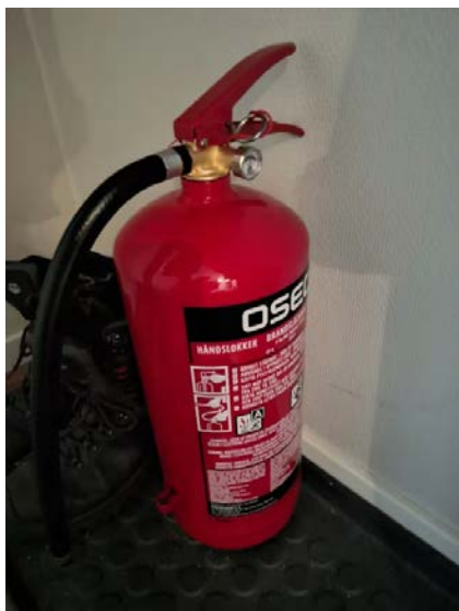
Brannslukningsapparat er plassert i entré.
