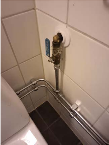
Hovedstoppekran er plassert på bad.
