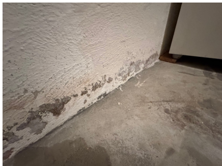
Tegn til at dreneringen ikke fungerer tilstrekkelig.
