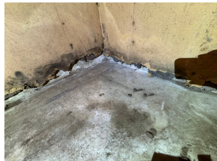
Tegn til at dreneringen ikke fungerer tilstrekkelig.
