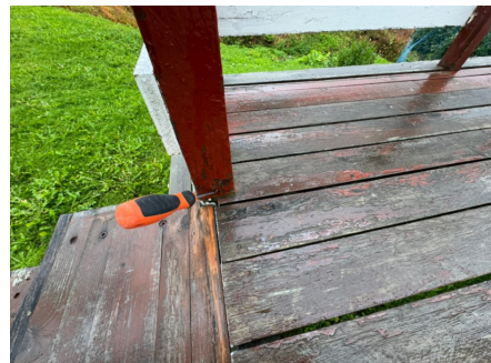
Råteskade i rekkverksstolpe.
