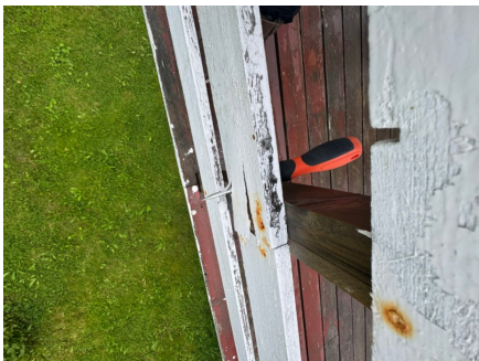
Råteskade i rekkverket.
