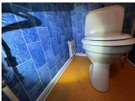
Vannledningen er ikke tilstrekkelig klamret fast.
