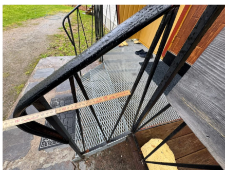
Åpninger i rekkverket.
