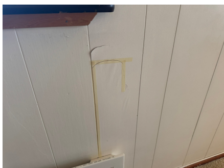
Eksempel på skade på innvendige overflater
