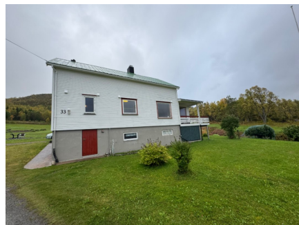
Eksempel på hvor det ikke er montert snøfangere hvor folk kan ferdes.
