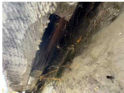
Det er ikke montert musesperre på tilbygget hvor det er luftespalte.
