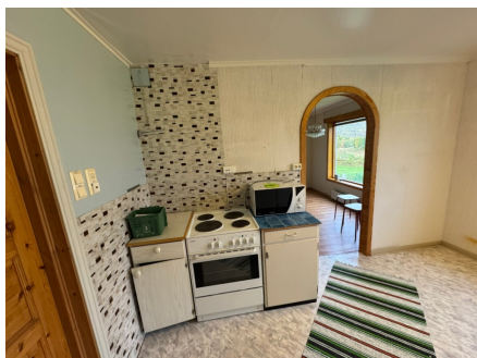
Det er ikke montert ventilator.
