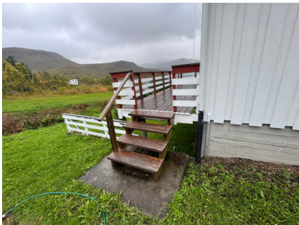
Det er ikke montert rekkverk på ene siden av trappen.
