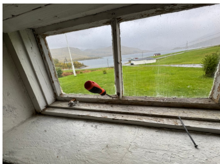
Vindu med råteskade.
