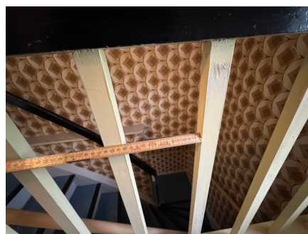
Åpninger i rekkverket.
