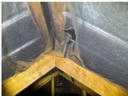
Eksempel på skade i undertaket.
