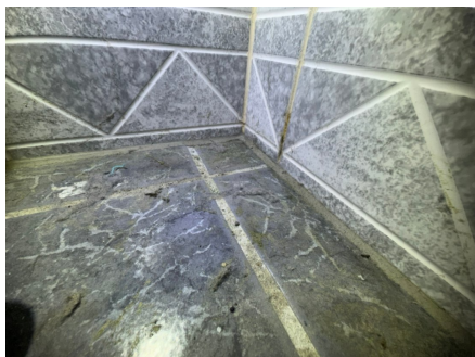
Tegn til fuktskade i plateskjøt.
