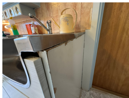
Eksempel på fuktsvelling i kjøkkeninnredningen.
