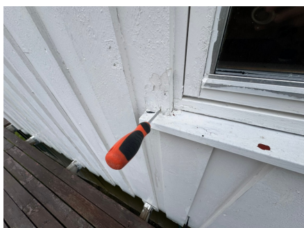
Eksempel på spredte råteskader.
