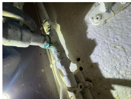
Drypping fra vannrøret i kjelleren.
