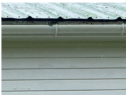
Eksempel på skade i takrennen.
