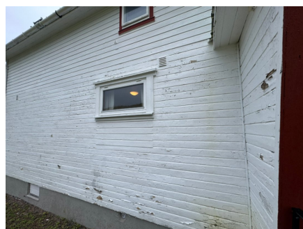
Kledninger er værslitt.
