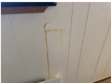
Eksempel på skade på innvendige overflater
