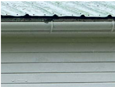
Eksempel på skade i takrennen.
