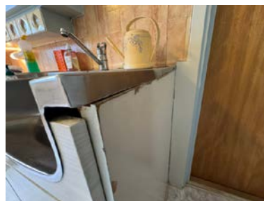
Eksempel på fuktsvelling i kjøkkeninnredningen.
