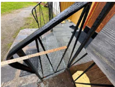
Åpninger i rekkverket.
