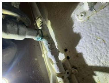
Drypping fra vannrøret i kjelleren.
