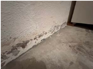
Tegn til at dreneringen ikke fungerer tilstrekkelig.
