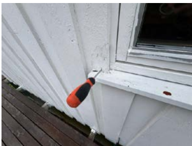
Eksempel på spredte råteskader.
