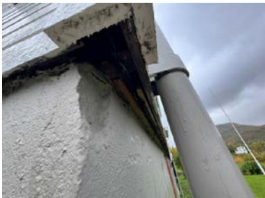
Det er ikke luftespalte bak kledningen på opprinnelig del.
