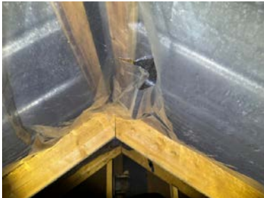
Eksempel på skade i undertaket.
