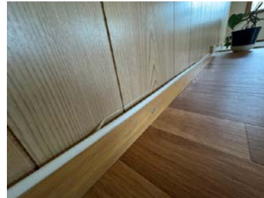
Ledningene i stuen har løsnet fra limet.
