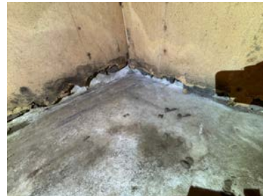
Tegn til at dreneringen ikke fungerer tilstrekkelig.
