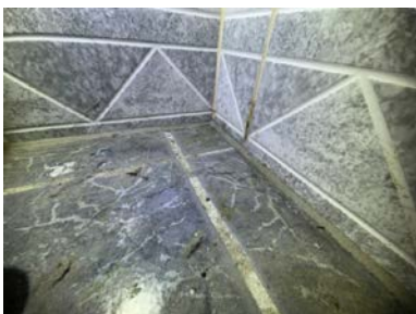
Tegn til fuktskade i plateskjøt.
