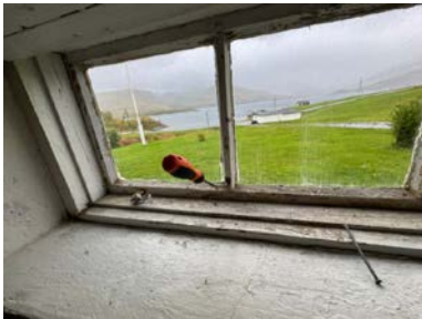
Vindu med råteskade.
