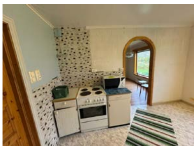
Det er ikke montert ventilator.
