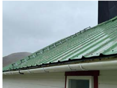
Slitasje på grunn av alder.
