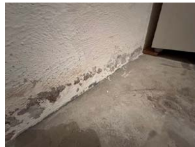
Saltutslag på veggen.
