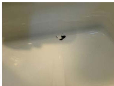
Hakk i dusjkabinettet.
