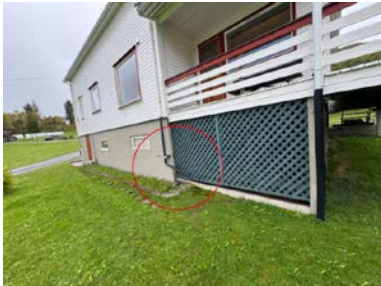
Takrennedløp som er avsluttet over terrenget.
