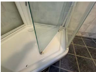
Løs dør i nedkanten.
