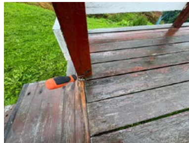
Råteskade i rekkverksstolpe.
