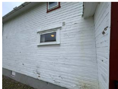
Kledninger er værslitt.
