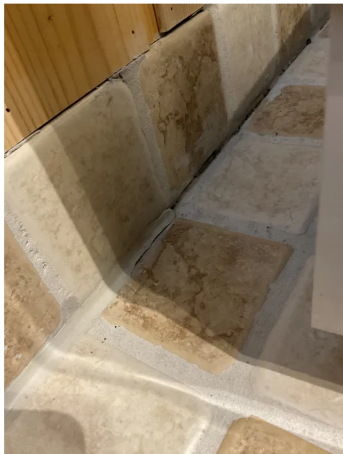
Noe manglende fug bak dusjkabinett
