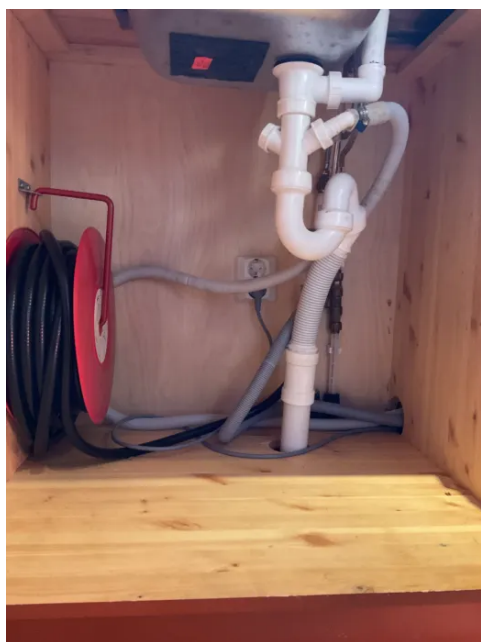
Synlige innvendige avløpsrør i PVC-plast
