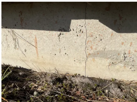
Enkelte riss uten byggteknisk forringelse
