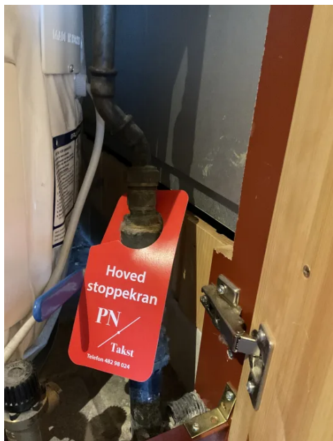
Hovedstoppekran med synlig merking
