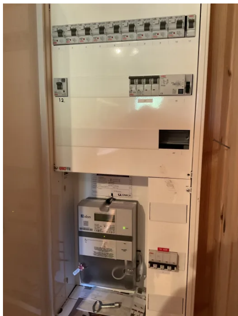
Sikringsskap plassert i bod
