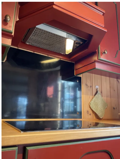
Ventilator over koketopp, komfyrvakt er ikke montert
