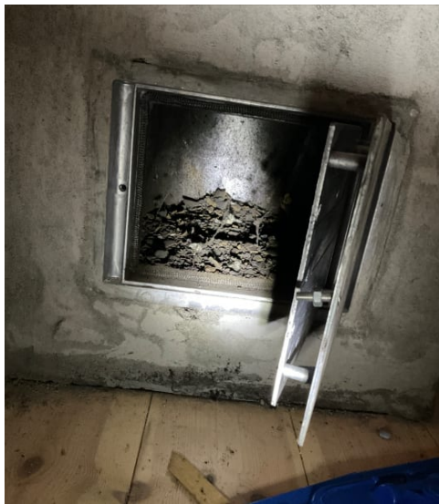
Sotlukestein må ettermonteres for å lukk avviket
