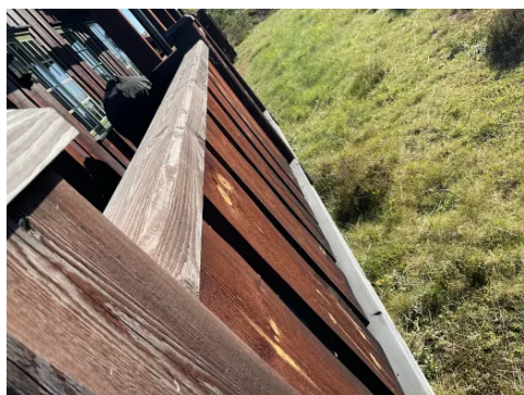
Ny overflatebehandling bør påregnes
