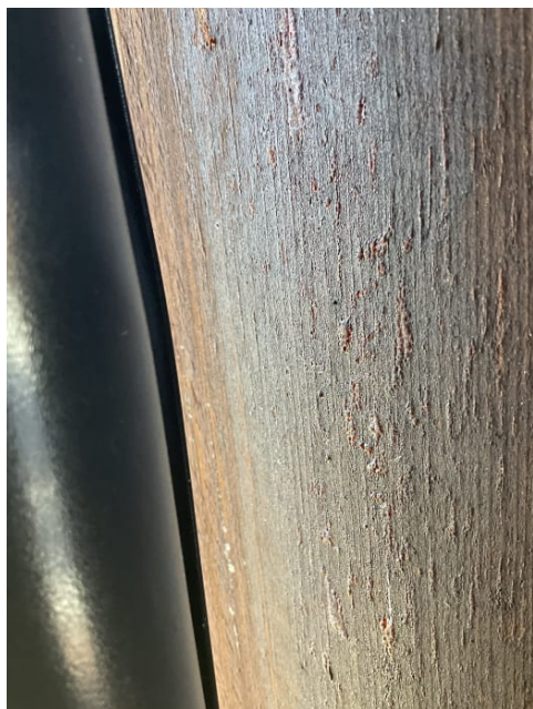
1-nedløp med deformasjonsskade
