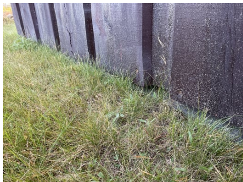
Ligger nært terreng og utsatt for fuktopptrekk
