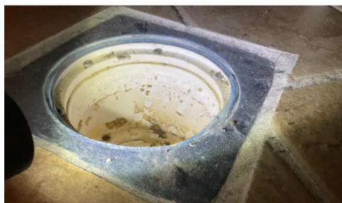
Slukmansjett synlig ført under klemring
