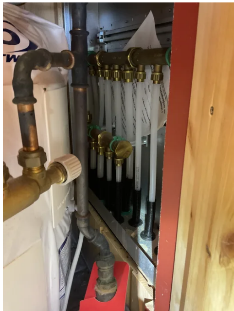
Fordelerskap med noe vanskelig adkomst
