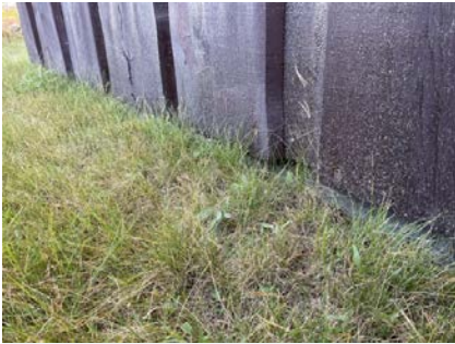
Ligger nært terreng og utsatt for fuktopptrekk
