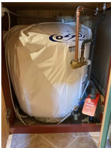
Bereder plassert i benkeskap på baderom
