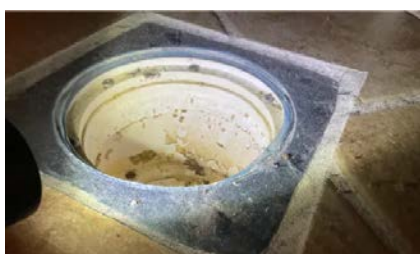
Slukmansjett synlig ført under klemring
