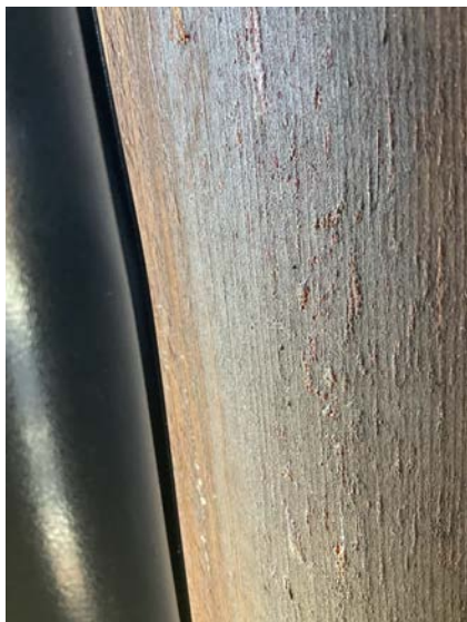
1-nedløp med deformasjonsskade
