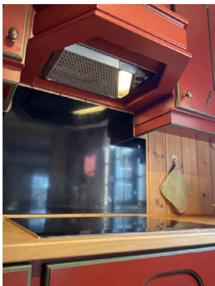
Ventilator over koketopp, komfyrvakt er ikke montert
