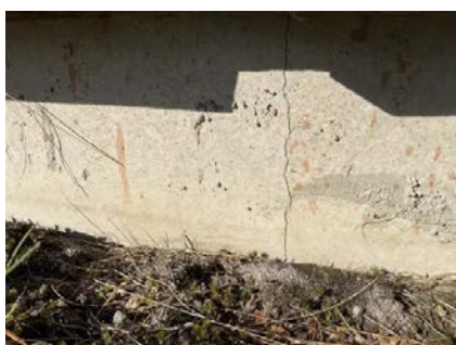
Enkelte riss uten byggteknisk forringelse
