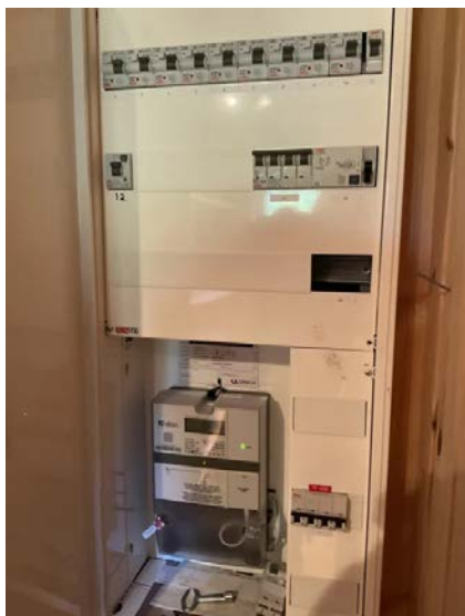
Sikringsskap plassert i bod
