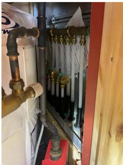
Fordelerskap med noe vanskelig adkomst
