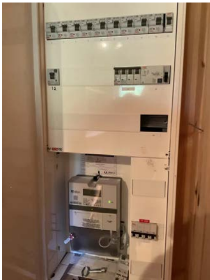
Sikringsskap plassert i bod
