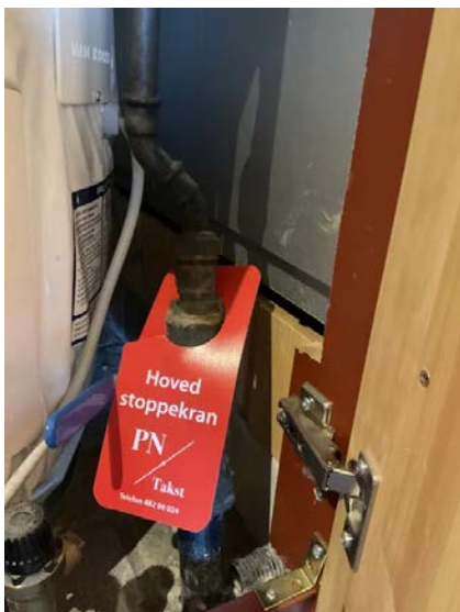
Hovedstoppekran med synlig merking
