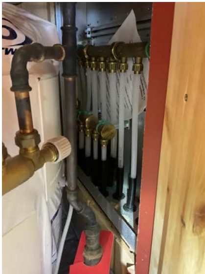
Fordelerskap med noe vanskelig adkomst
