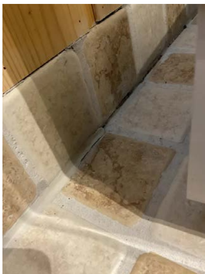
Noe manglende fug bak dusjkabinett
