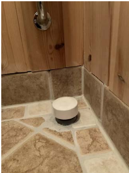
Kloakklufting med kloakkventil
