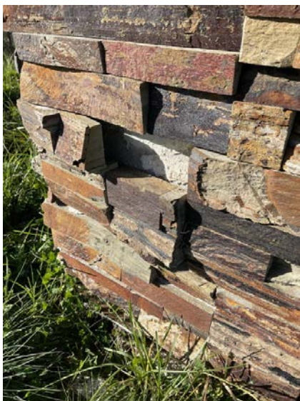
Noe løse forblendingssteiner over tak
