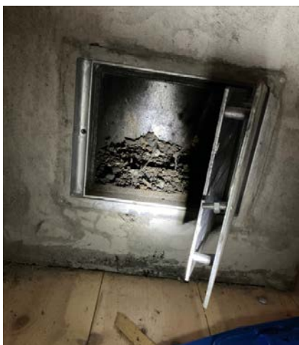
Sotlukestein må ettermonteres for å lukk avviket
