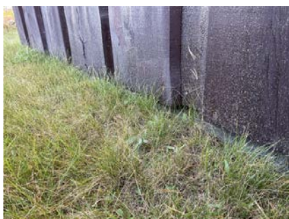
Ligger nært terreng og utsatt for fuktopptrekk
