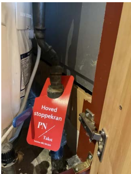
Hovedstoppekran med synlig merking
