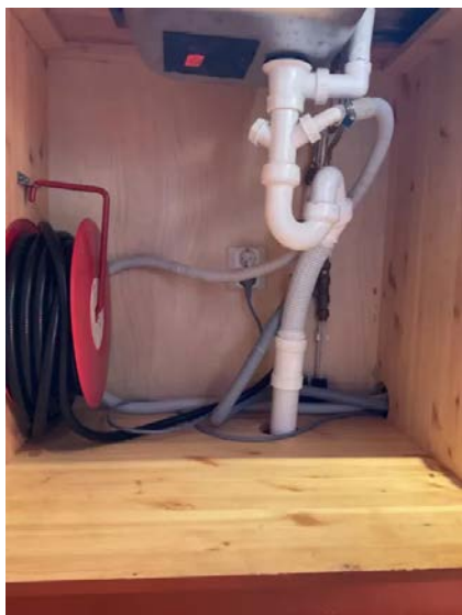
Synlige innvendige avløpsrør i PVC-plast
