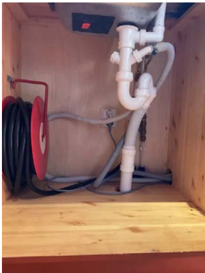
Synlige innvendige avløpsrør i PVC-plast
