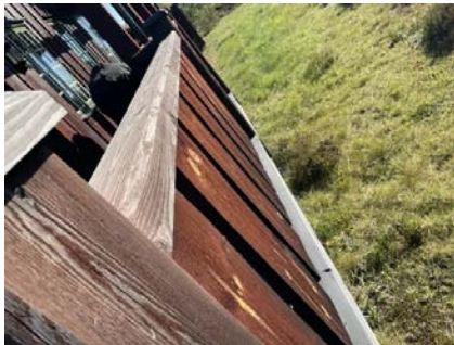
Ny overflatebehandling bør påregnes
