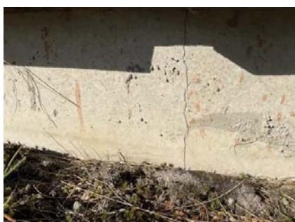
Enkelte riss uten byggteknisk forringelse
