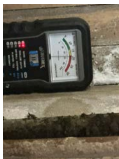
Utslag ved fuksøk i gulv i kjeller.
