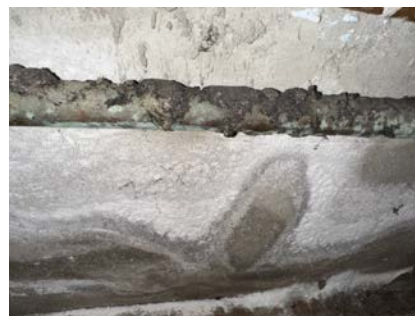
Saltutslag etter fuktvandring i synlig murvegg.
