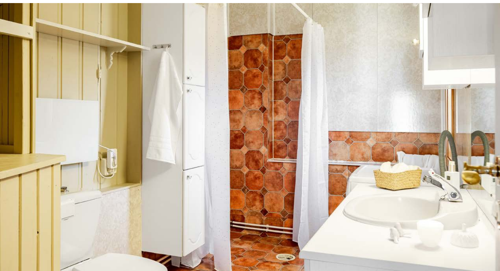
Eldre bad/vaskerom antatt fra tilbyggingsåret. Baderommet har fått TG3 i tilstandsrapporten og må oppgraderes for å tåle normal bruk etter dagens krav. Det anbefales at baderommet totalrenoveres.
