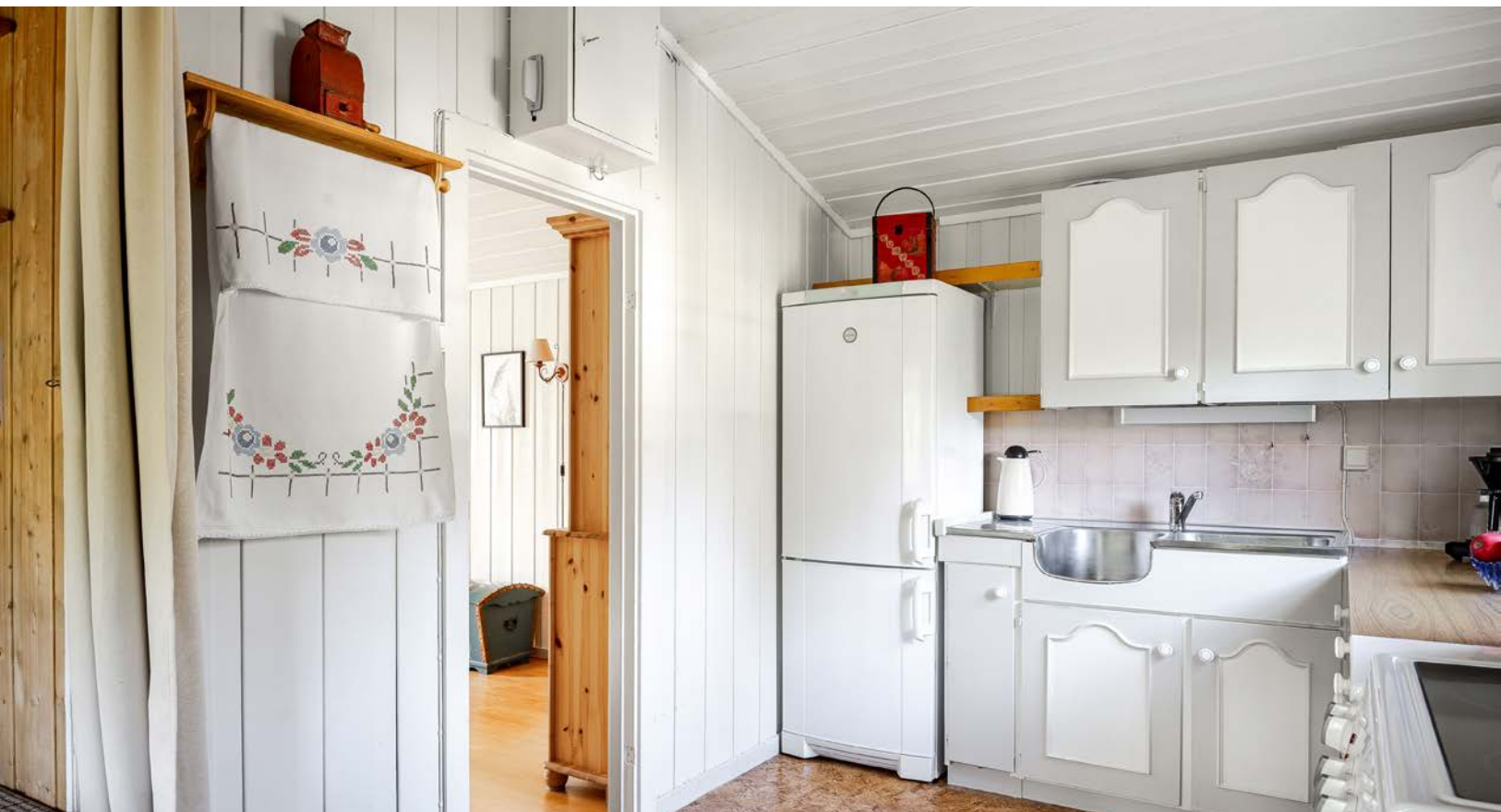
Sikringsskap med skrusikringer (porselensikringer) montert på vegg på kjøkken. Det elektriske anlegget ble sist gang kontrollert den 06.07.2021, uten pålegg om utbedringer.
