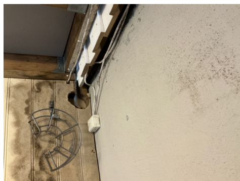
Synlig rennmerker fra fukt. Veggplater er skadet
