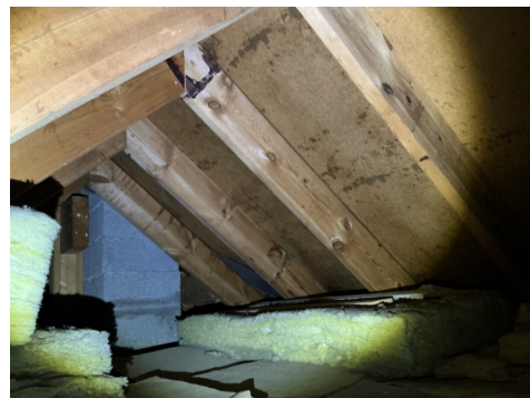
Inspisert ved å lyse og kikke opp av luke over klesskap på ene soverommet.
