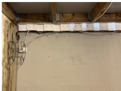
Gliper mellom fasade og bod vegg
