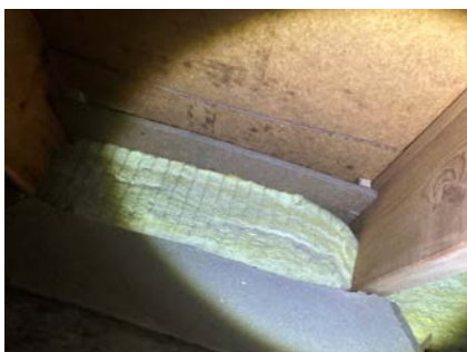
Luftespalte registrert etablert på isolert del av skråtak
