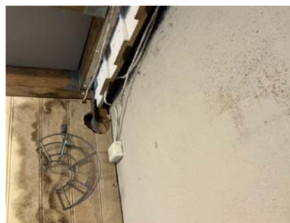
Synlig rennmerker fra fukt. Veggplater er skadet
