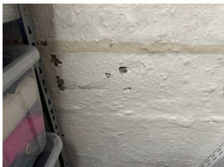
Tegn til saltutslag/ løs maling i garasjen.
