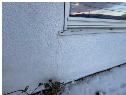
Eksempel på riss i grunnmuren.
