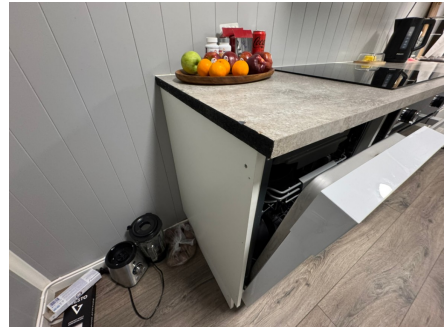
Det er ikke kantlist på benkeplaten.
