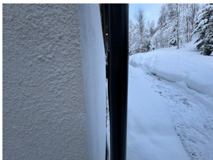
Eksempel på frostspreng på nedløpsrør.
