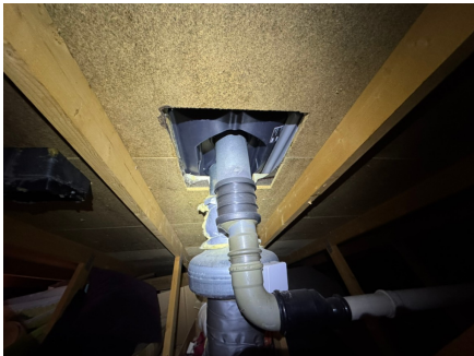
Rør som ikke er isolert.
