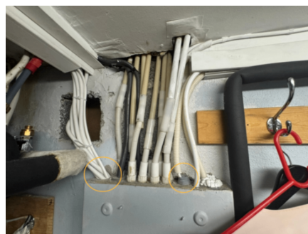
Utettheter i sikringsskapet.
