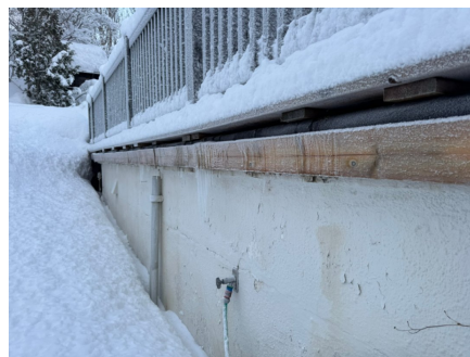
Det er ikke montert takrenne på garasjen.
