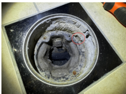
Utettheter i membranen ved sluken.
