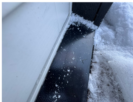
Beslaget på balkongdøren til stuen går ikke under/i sporet på døren.
