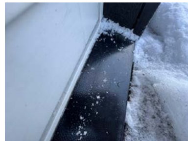
Beslaget på balkongdøren til stuen går ikke under/i sporet på døren.
