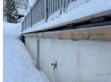
Det er ikke montert takrenne på garasjen.
