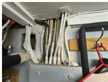
Uttettheter i sikringsskapet.
