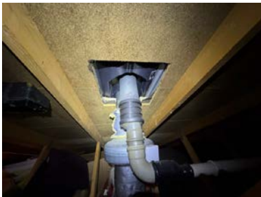
Rør som ikke er isolert.
