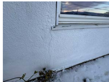
Eksempel på riss i grunnmuren.
