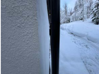
Eksempel på frostspreng på nedløpsrøret.
