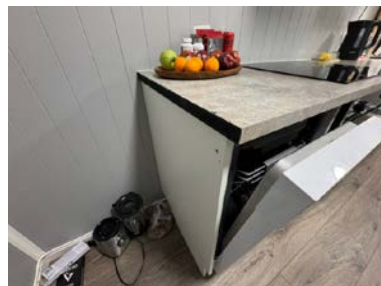
Det er ikke kantlist på benkeplaten.
