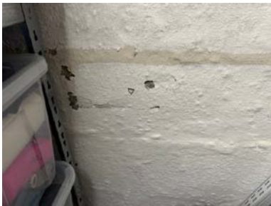
Tegn til saltutslag/ løs maling i garasjen.
