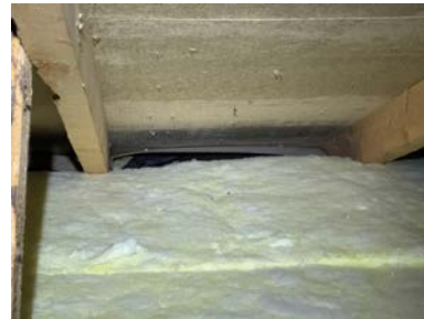
Eksempel på deformert pappkubbing.
