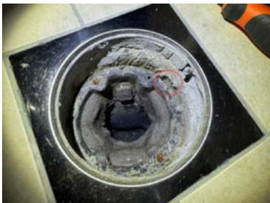
Utettheter i membranen ved sluken.
