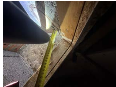
Det er ikke tilstrekkelig avstand fra sotluken til brennbart materiale.
