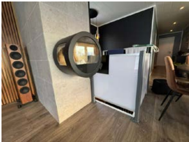
Det er ikke ildfast plate under vedovnen.
