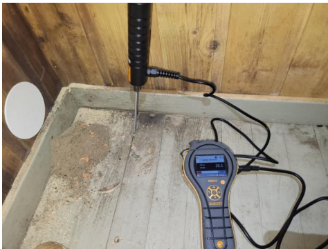
Fuktmåling i gulv med pigger og påviste forhøvede fuktverdier.
