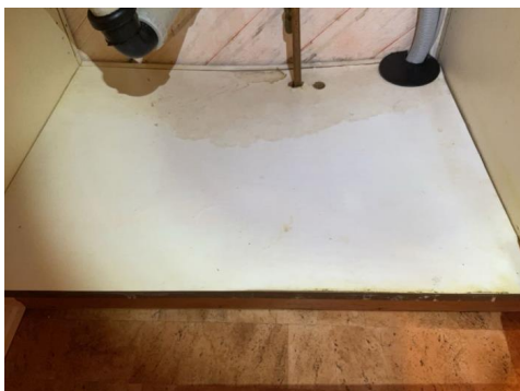
Vannskader i bunnplate.
