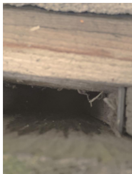
Manglende musebånd under kledning.
