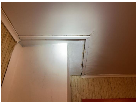
Rennemerker etter sotvann i himling i loftetasje.
