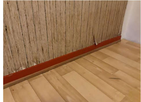
Skade på strie på soverom i loftetasjen.
