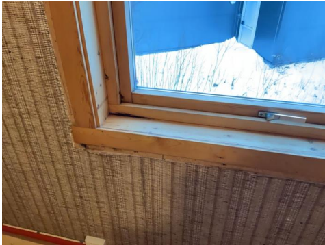
Fuktskade i karm på vindu i loftetasje
