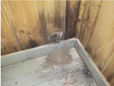
Hullboring i fuktskadet vegg. Løs masse kom ut av veggen.
