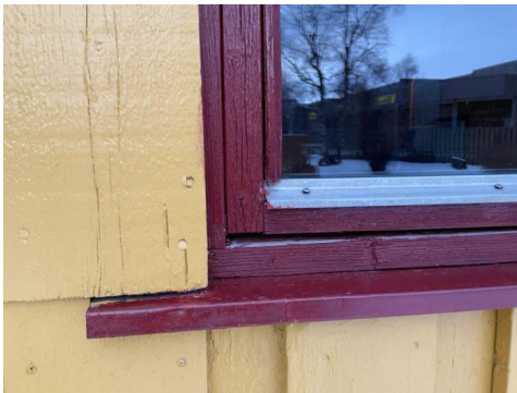
Sprekker i utvendig vinduskarm
