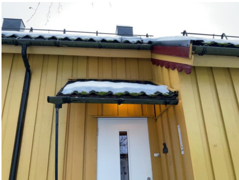
Lekkasje i takkonstruksjon over tilbygg.
