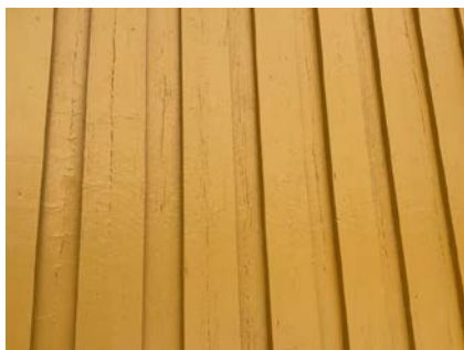
Sprekker i kledning.
