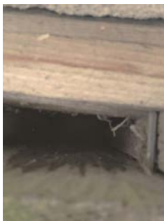
Manglende musebånd under kledning.
