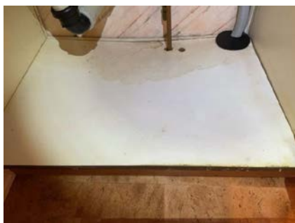
Vannskader i bunnplate.
