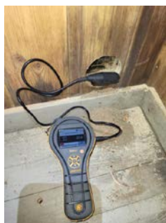
Det er konstatert høyt fuktnivå og synlig skade i vegg.
