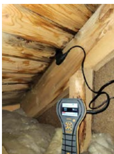
Påvist lekkasje og fuktskade i takkonstruksjon mot sør.
