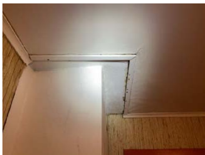
Rennemerker etter sotvann i himling i loftetasje.
