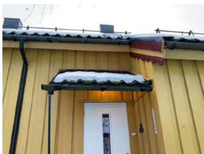
Lekkasje i takkonstruksjon over tilbygg.
