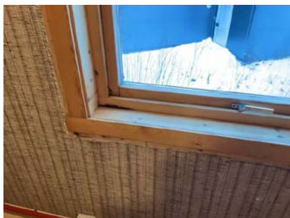
Fuktskade i karm på vindu i loftetasje
