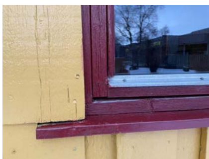
Sprekker i utvendig vinduskarm
