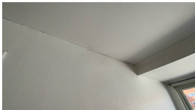
Synlige avvik på overflater.
