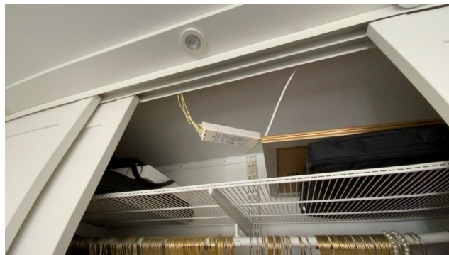
Transformator i garderobeskap bør ytterligere festes.
