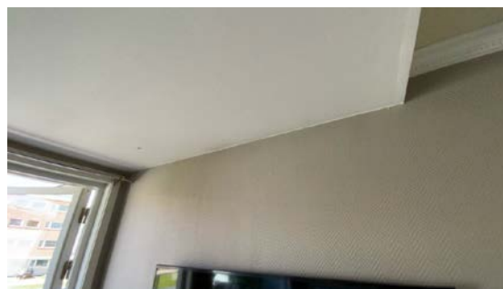
Synlige avvik på overflater.
