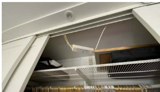
Transformator i garderobeskap bør ytterligere festes.
