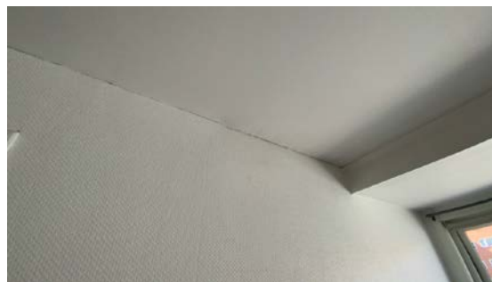
Synlige avvik på overflater.
