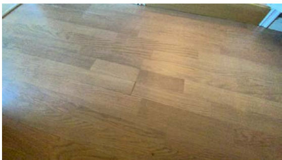
Synlige avvik på overflater.
