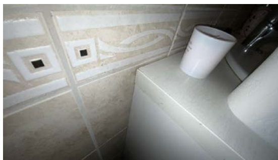
Mindre skader på innredning.
