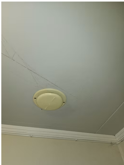
Bilde viser fuktmerker rundt avtrekksventil.
