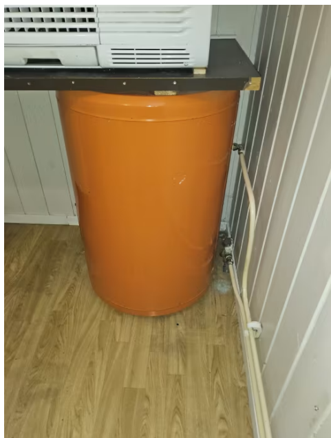
Bilde viser varmtvannsbereder på vaskerom.
