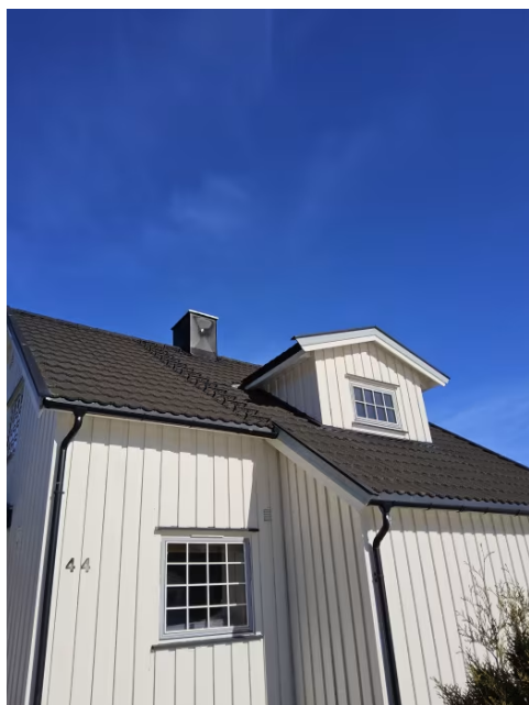
Bilde viser manglende bruk av snøfanger.
