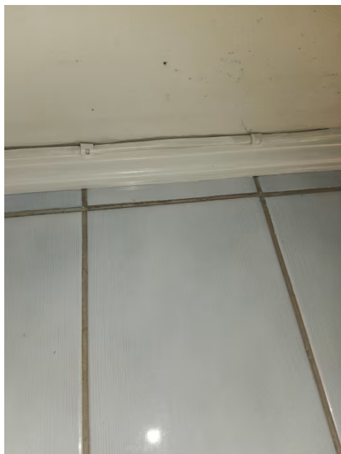
Bilde viser riss og løs flis.
