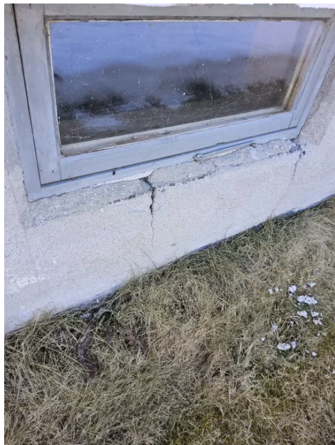
Bilde viser riss/sprekke i grunnmur.
