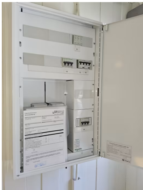
Bilde viser sikringsskap på loft.
