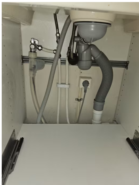
Bilde viser røropplegg under oppvaskkum på kjøkken.
