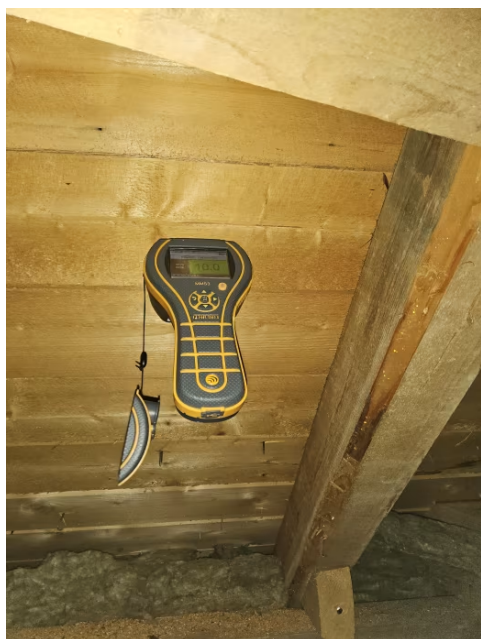
Bilde viser fuktmåling i taktro.
