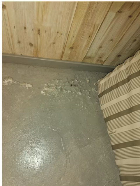
Bilde viser saltutslag på gulvflate i kjeller.
