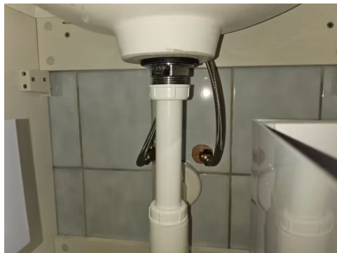
Bilde viser mangelfull tetting av rørgjennomføring.
