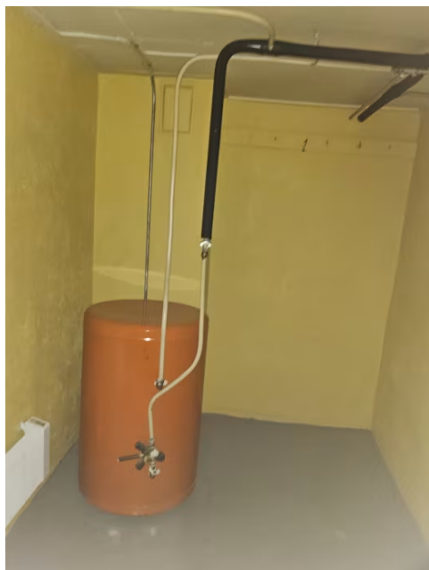
Bilde viser varmtvannsbereder i grovkjeller.
