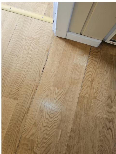
Bilde viser sprekk i gulv.
