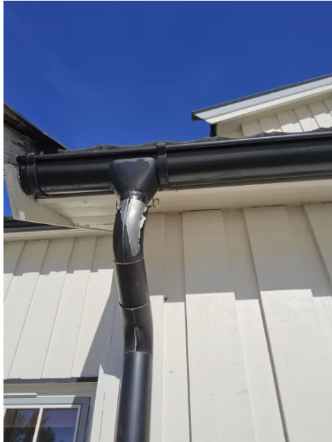
Bilde viser avflassing på taknedløp.
