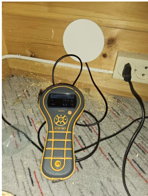
Bilde viser fuktmåling i utlektet kjellervegg.
