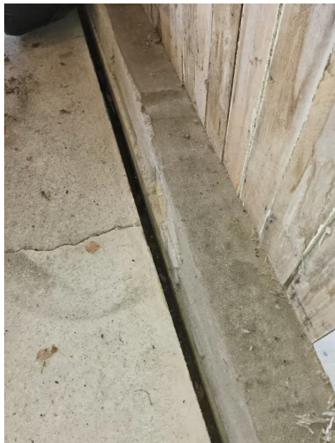
Bilde viser sprekke mellom betongplate og grunnmur etter setningsskade.
