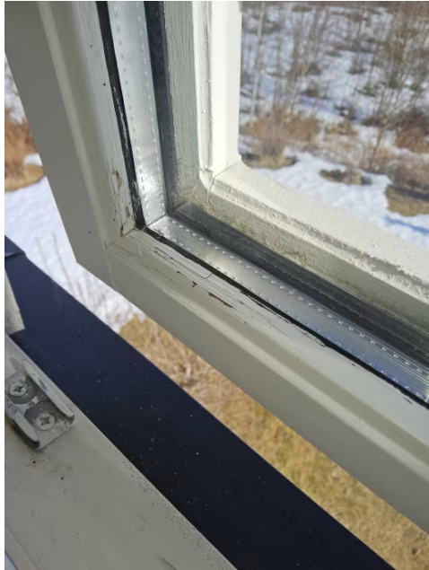
Bilde viser fuktskadet vindu.
