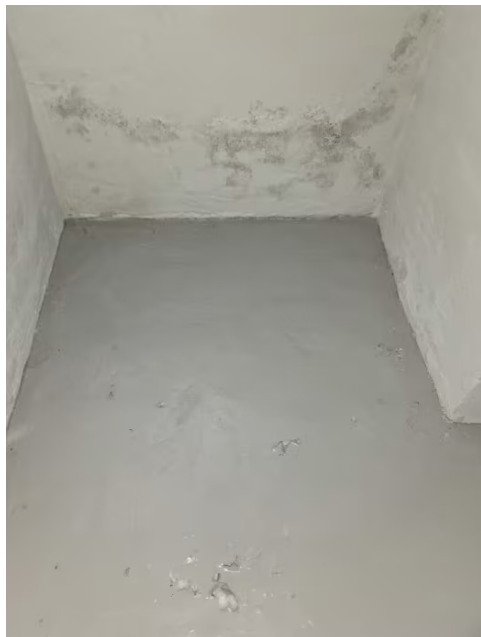
Bilde viser saltutslag på kjellervegg.
