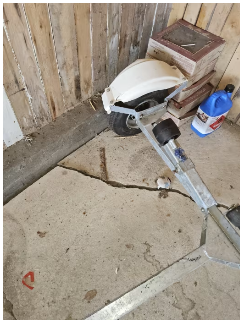
Bilde viser knekt betongplate.
