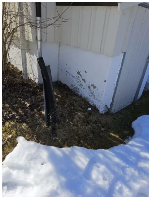
Bilde viser mangelfull bortledning av takvann.
