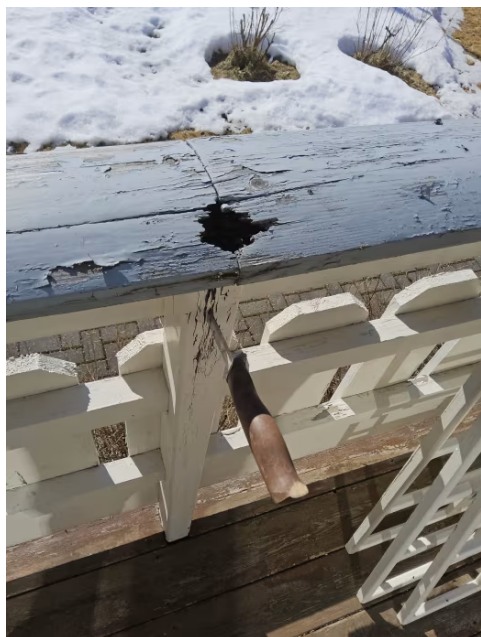
Bilde viser råteskadet rekkverk.
