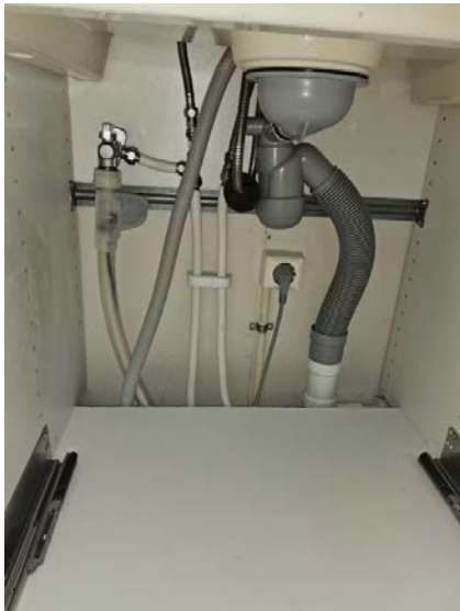
Bilde viser røropplegg under oppvaskkum på kjøkken.
