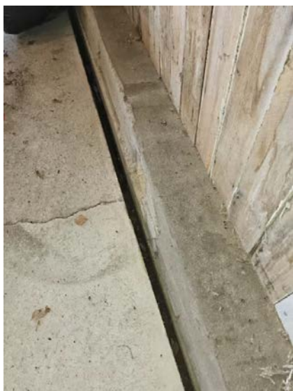
Bilde viser sprekk mellom betongplate og grunnmur etter setningsskade.
