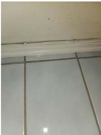
Bilde viser riss og løs flis.
