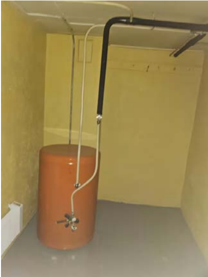
Bilde viser varmtvannsbereder i grovkjeller.
