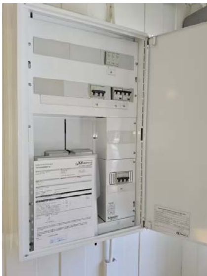
Bilde viser sikringsskap på loft.
