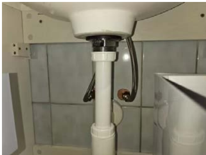
Bilde viser mangelfull tetting av rørgjennomføring.
