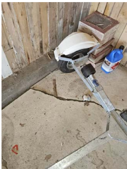
Bilde viser knekt betongplate.
