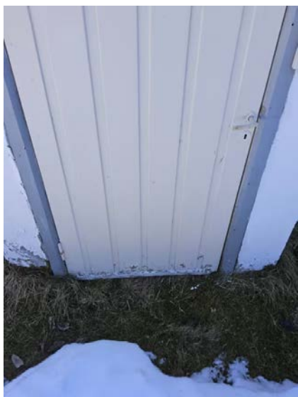
Bilde viser dør til kjeller med høy slitasjegrad.
