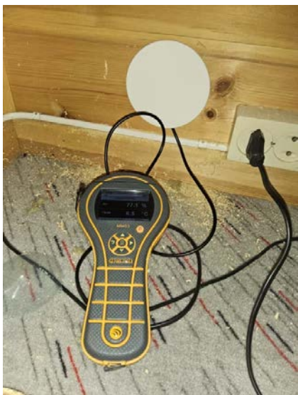
Bilde viser fuktmåling i utlekket kjellervegg.
