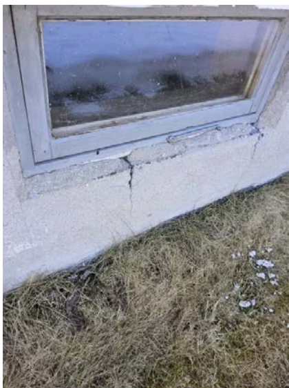
Bilde viser riss/sprekk i grunnmur.
