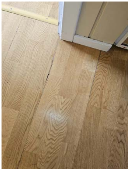
Bilde viser sprekk i gulv.
