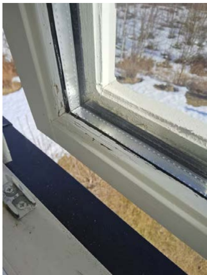
Bilde viser fuktskadedt vindu.
