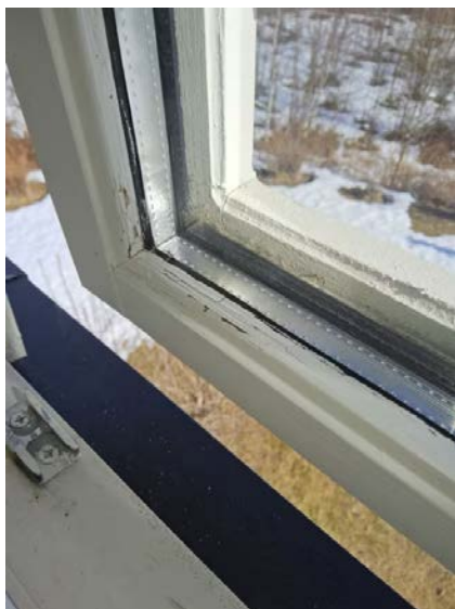
Bilde viser fuktskade på vindu som følge av redusert ventilering av boligen.
