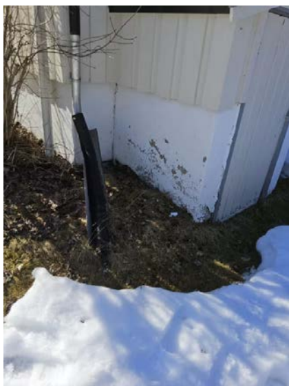
Bilde viser mangelfull bortledning av takvann.
