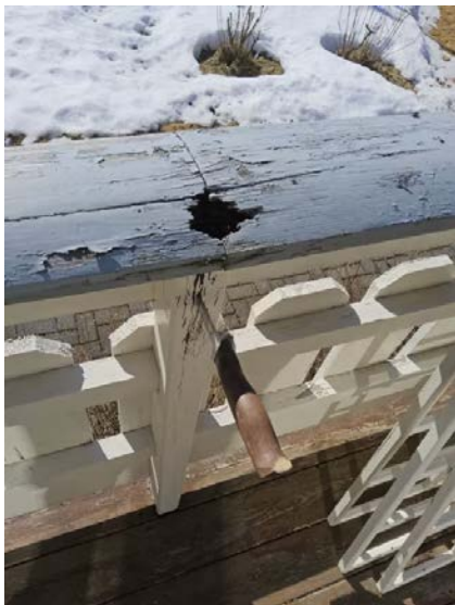
Bilde viser råteskadet rekkverk.
