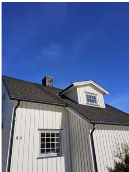
Bilde viser manglende bruk av snøfanger.
