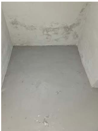
Bilde viser saltutslag på kjellervegg.
