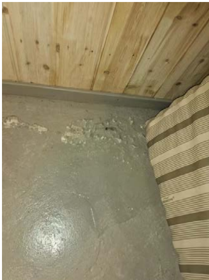
Bilde viser saltutslag på gulvflate i kjeller.
