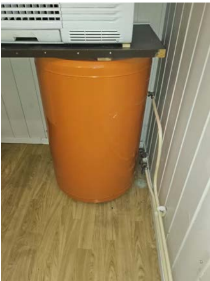
Bilde viser varmtvannsbereder på vaskerom.
