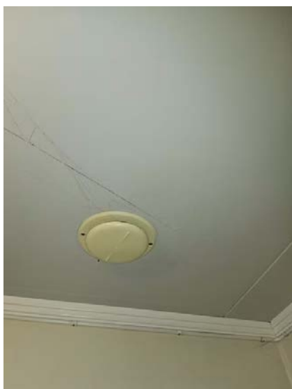
Bilde viser fuktmerker rundt avtrekksventil.
