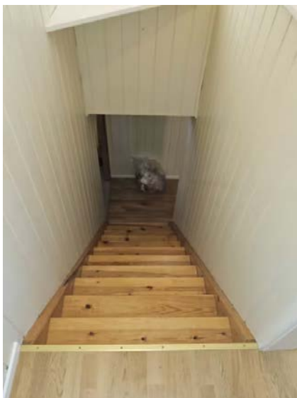
Bilde viser trapp uten rekkverk.
