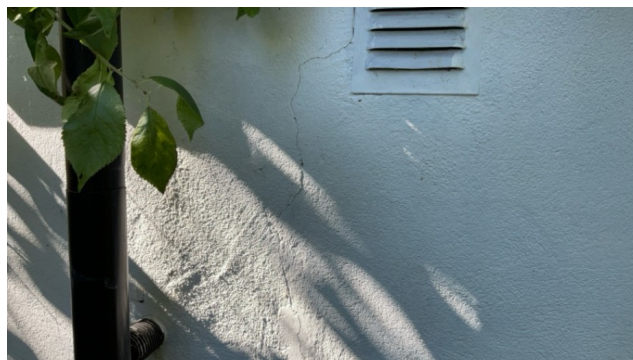
Sprekk i grunnmur.
