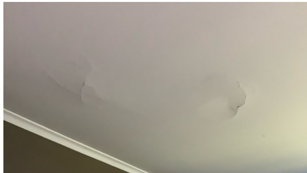
Skade i himlig.
