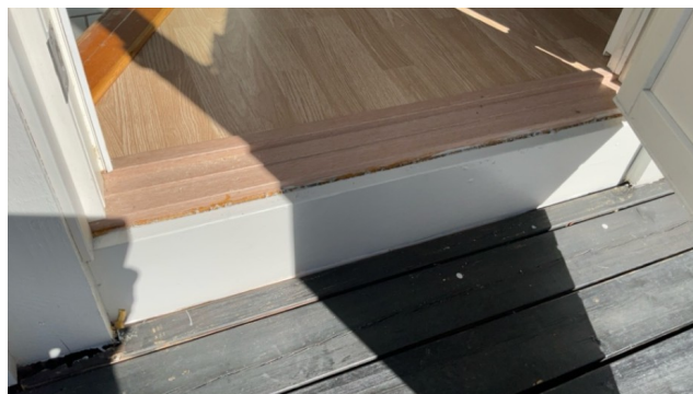
Beslag mangler under dør.
