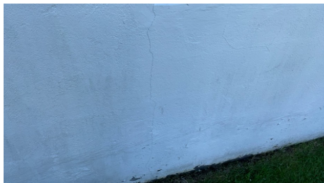
Sprekk i grunnmur.
