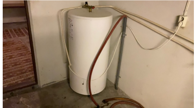
Bereder montert i kjeller.
