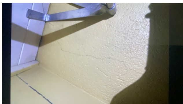
Sprekk i pipe.
