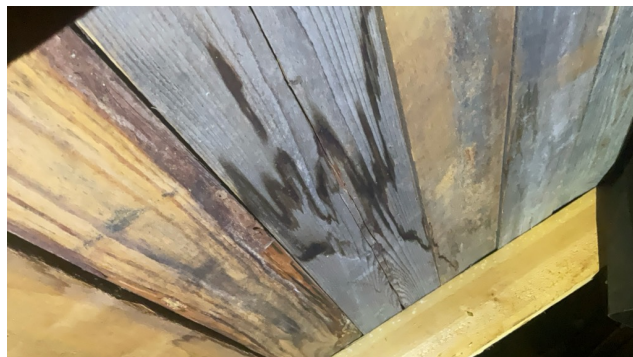
Fuktskjolde i taktro.
