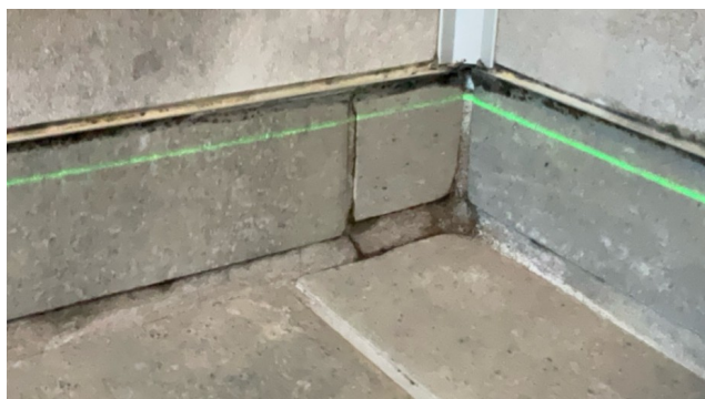
Riss/sprekker i flisfuger i våtsone.
