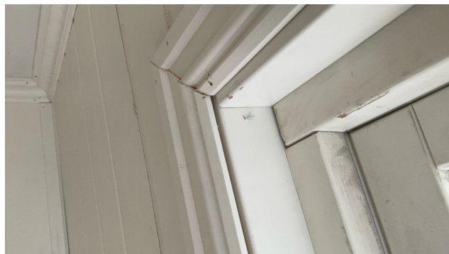
Eksempel på ufagmessig utførelse på diverse overflater.
