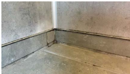
Eksempel på svertesopp i dusjsone.
