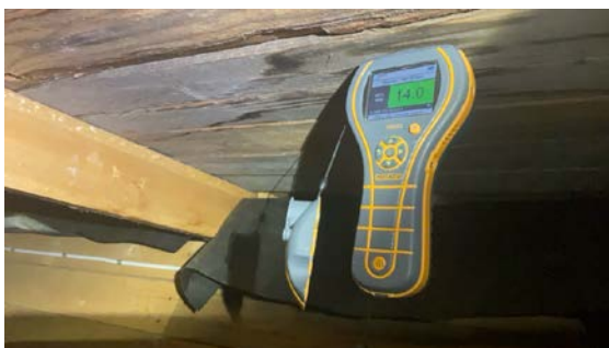
Det er utført fuktmåling med pigger uten unormale resultater i fuktskjolder. Noe forhøyede, men ikke fuktig resultat.
