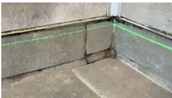
Riss/sprekker i flisfuger i våtsone.
