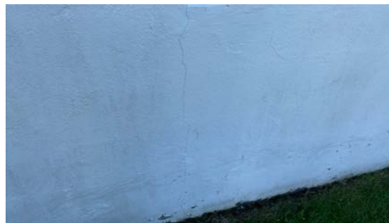
Sprekk i grunnmur.
