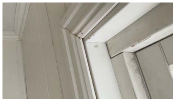
Eksempel på ufagmessig utførelse på diverse overflater.
