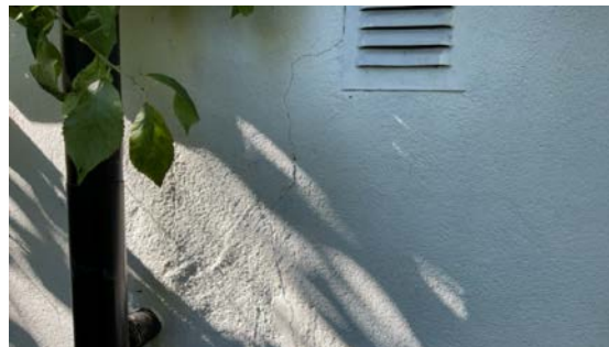
Sprekk i grunnmur.
