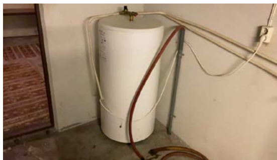
Bereder montert i kjeller.
