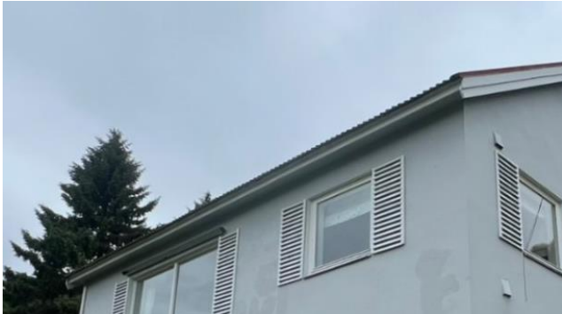
Eksempel på manglende takrenner.
