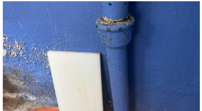
Rust på avløpsrør
