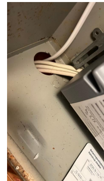
Gjennomføringer i sikringsskapet er ikke beskyttet
