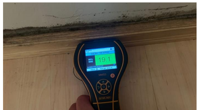
Fuktmåling i fotlist montert mot grunnmuren gir høye fuktverdier
