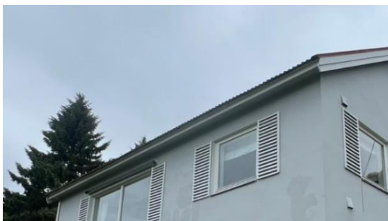
Eksempel på manglende takrenner.
