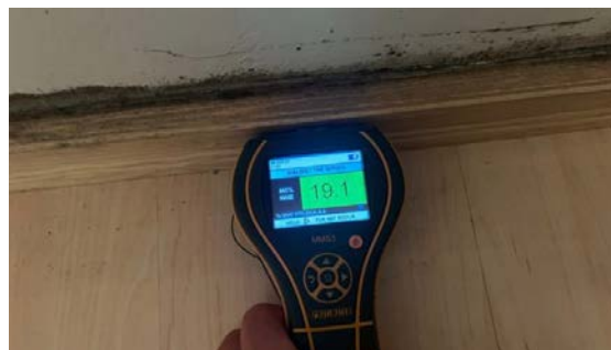
Fuktmåling i fotlist montert mot grunnmuren gir høye fuktverdier
