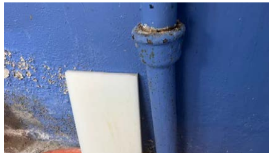
Rust på avløpsrør
