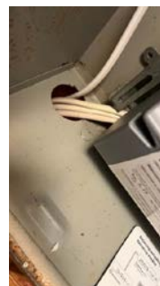
Gjennomføringer i sikringsskapet er ikke beskyttet
