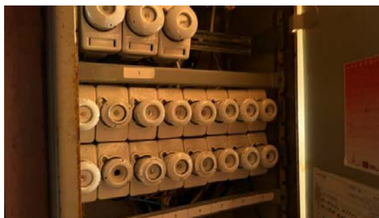
Sikringskap med skrusikringer
