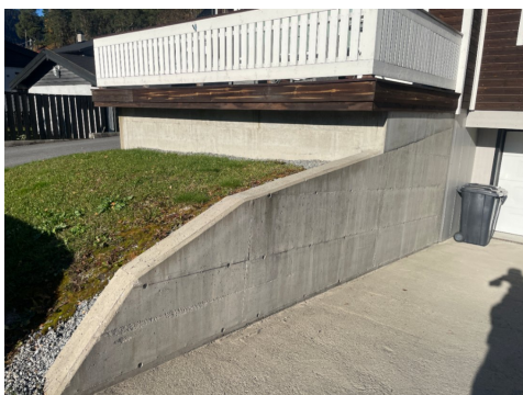
Støttemurer mot nedkjøring til garasje mangler rekkverk el. annen sikring
