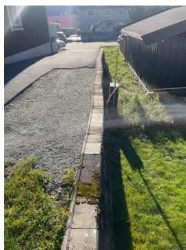
Synlig retningsavvik og det mangler rekkverk el. annen sikring.
