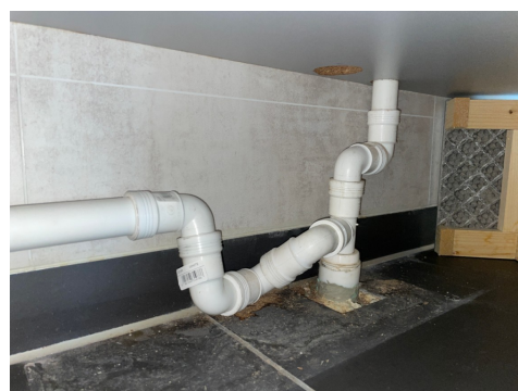
Usikker rørgjennomføring. Må dokumenteres.
