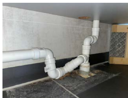
Usikker rørgjennomføring. Må dokumenteres.
