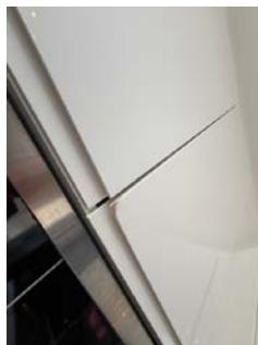
Noe mindre skader på enkelte fronter
