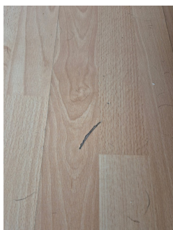
Skade på laminatgulv på kjøkken.
