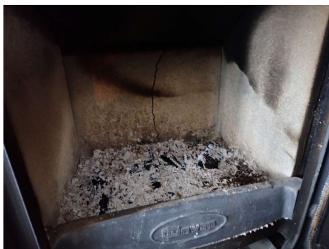
Viser ildfast stein med sprekk.
