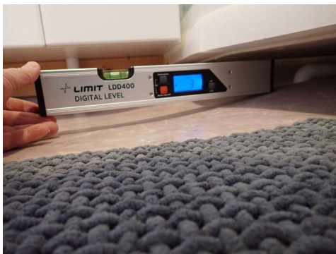
Viser motfall og opphøyet og skjev gulvsluk.
