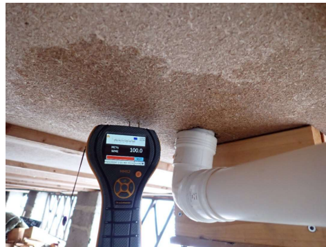
Viser fuktmåling i stubbloftsplater under kjøkken med høye verdier av fukt.
