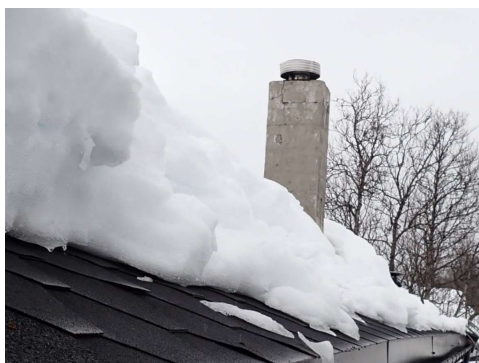
Viser pipe med sprekker over tak.
