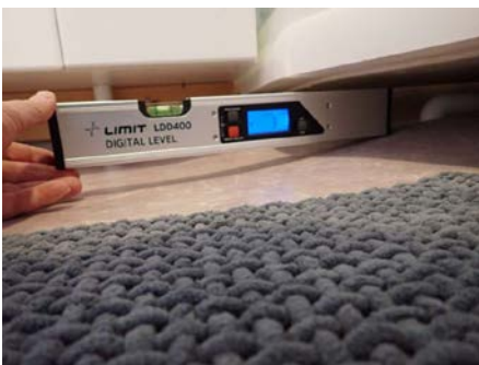
Viser motfall og opphøyet og skjev gulvsluk.
