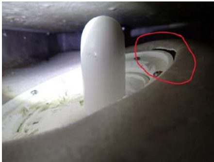
Viser tetthet rundt gulvsluk.
