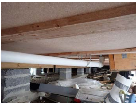
Viser avløp fra kjøkken med ingen fall.
