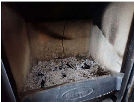
Viser ildfast stein med sprekk.
