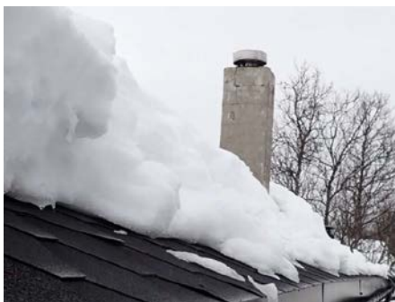
Viser pipe med sprekker over tak.
