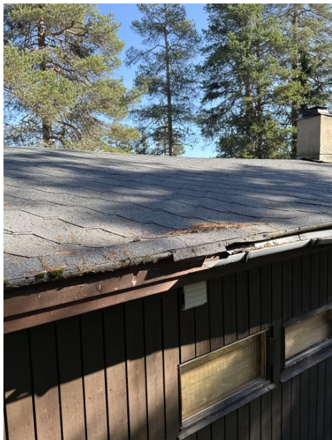
Det registreres stor nedbøy i takflaten flere steder.
