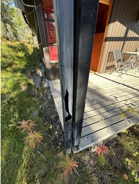
Viser sprekk i nedløpsrør.
