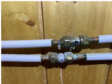
Det registreres irr og mindre drypplekkasje ved rørkobling på bad.
