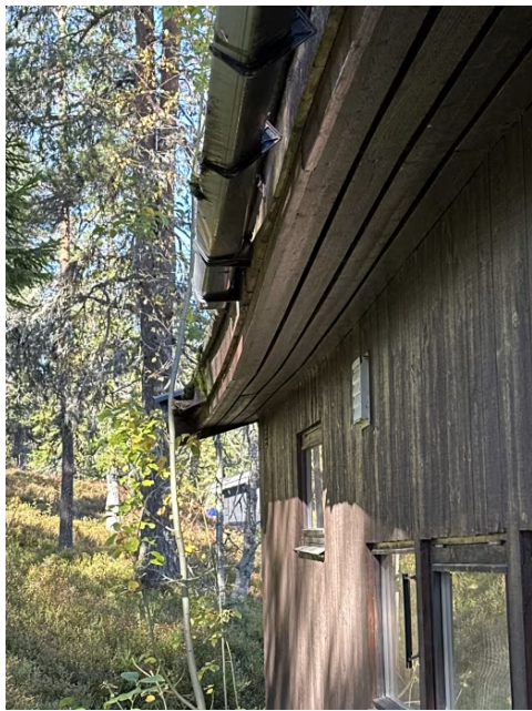
Viser skjevheter ved takkonstruksjonen.
