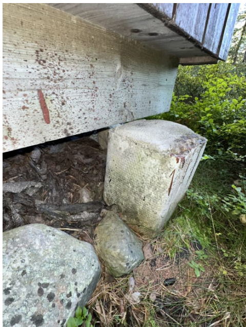
Viser eksempel på setningskader/skjevheter ved fundamenter.
