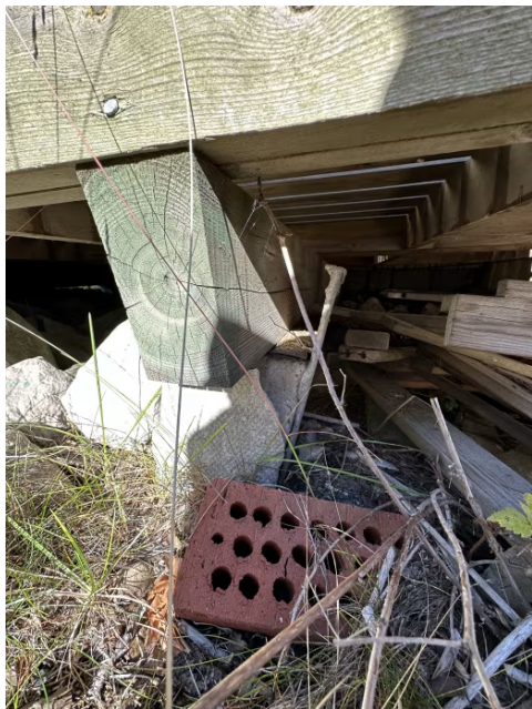
Viser eksempel på setningskader/skjevheter ved fundamenter.
