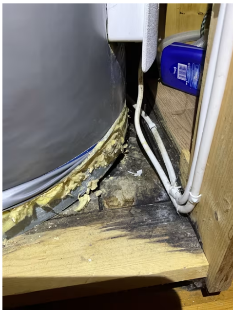
Viser defekt understøtte ved bereder.
