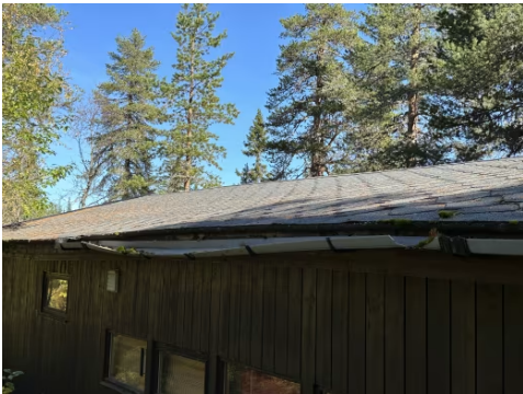
Det registreres store skader ved takrenner.
