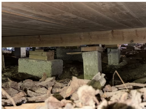
Viser svikt ved grunnen og bjelker som ikke er understøtter.
