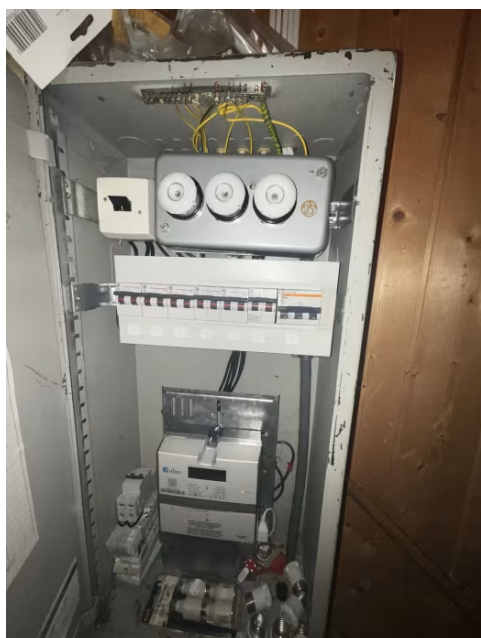
Viser sikringskapskapp plassert i utvendig bod. Inntak med skrusikringer, automater for forbrukskurser og måler.
