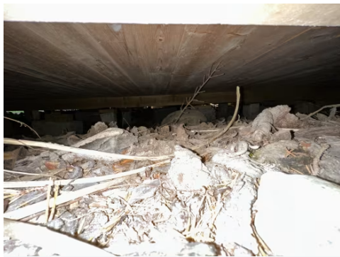
Det er liten avstand mellom stubbloftkonstruksjon og terreng.
