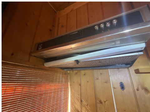
Viser ventilator med defekt rist/filter.
