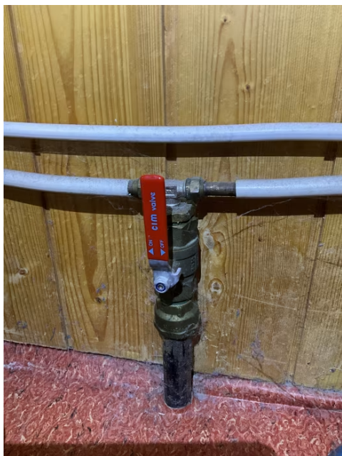
Viser vanninntak og hovedstoppekran plassert på bad.
