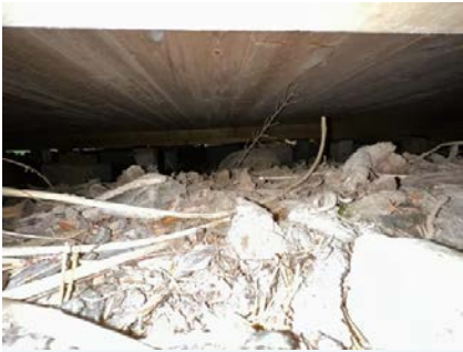
Det er liten avstand mellom stubbloftkonstruksjon og terreng.
