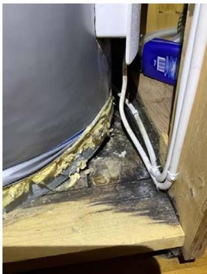
Viser defekt understøtte ved bereder.
