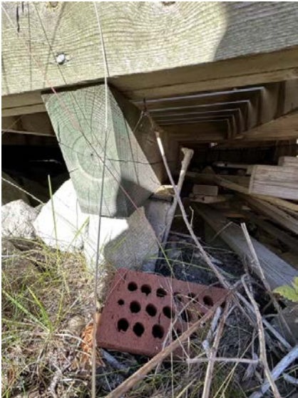
Viser eksempel på setningskader/skjevheter ved fundamenter.
