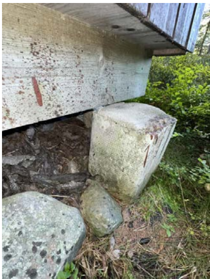
Viser eksempel på setningskader/skjevheter ved fundamenter.
