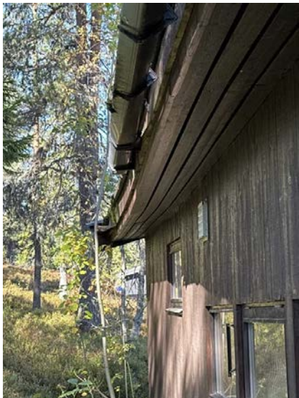
Viser skjevheter ved takkonstruksjonen.
