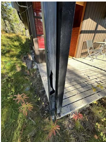
Viser sprekk i nedløpsrør.
