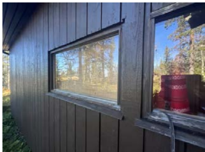
Det er påvist avvik ved omramming. Vindu mangler, gummlist, vannbrett og listverk.
