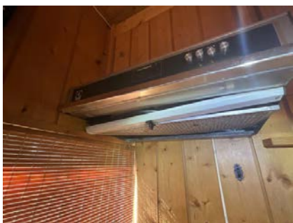
Viser ventilator med defekt rist/filter.
