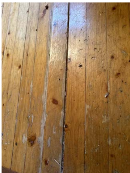
Det registreres store sprekker og slitasje ved gulv.
