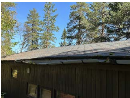
Det registreres store skader ved takrenner.
