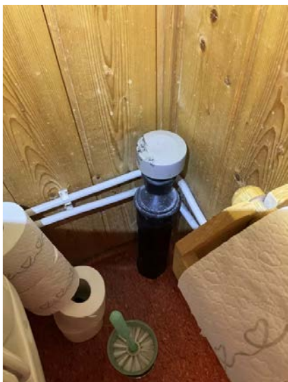
Viser lufting med vakumventil.
