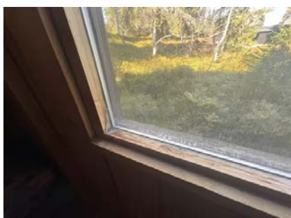
Det registreres misfarging på innvendige karmmer og foringer, trolig pga. kondens.
