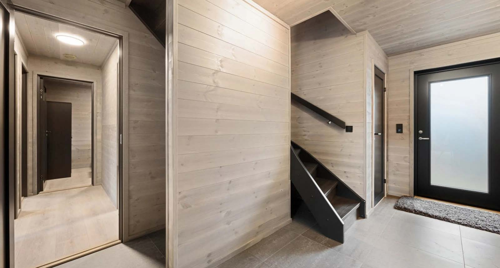
Varmekabler i flislagt gulv entre/gang.
